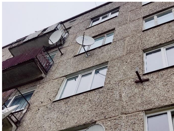
Attēls Nr. 212 Televīzijas satelītšķīvji. Nepieciešams veikt vājstrāvas tīklu un vājstrāvas sistēmu auditu. Nefunkcionējošās sistēmas nepieciešams demontēt!
