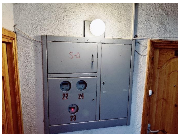
Attēls Nr. 203 Metāla elektrības skapis kāpņu telpā ar viedajiem skaitītājiem un apgaismojumu virs tā
