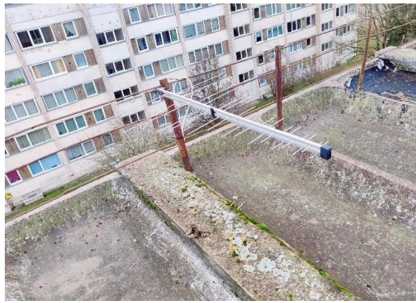
Attēls Nr. 210 Televīzijas antenas uz ēkas jumta. Nepieciešams veikt vājstrāvas tīklu un vājstrāvas sistēmu auditu. Nefunkcionējošās sistēmas nepieciešams demontēt!
