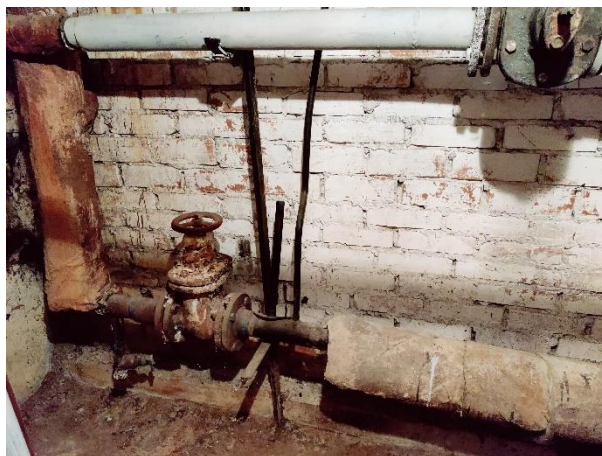
Attēls Nr. 189 Centrālapkures caurules un ventīļi
