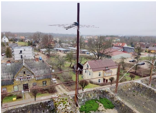
Attēls Nr. 209 Televīzijas antenas uz ēkas jumta. Nepieciešams veikt vājstrāvas tīklu un vājstrāvas sistēmu auditu. Nefunkcionējošās sistēmas nepieciešams demontēt!
