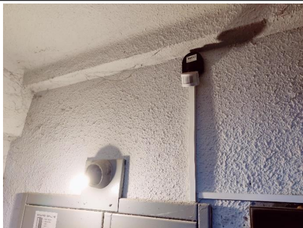
Attēls Nr. 201 Kāpņu telpās uzstādīts sienas apgaismojums ar kustību sensoru
