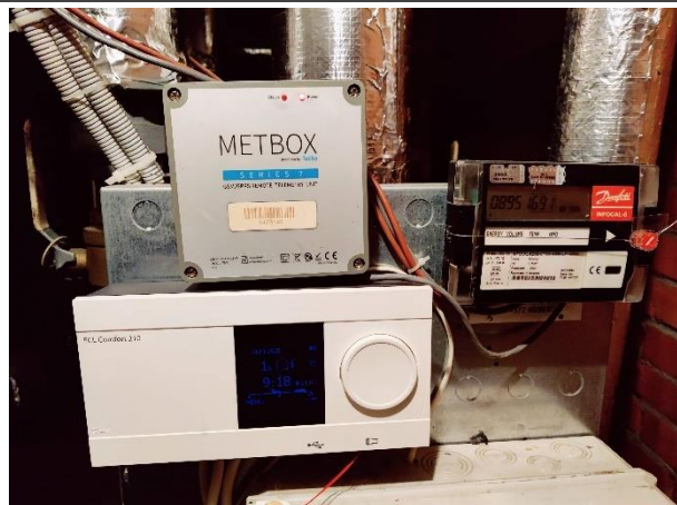
Attēls Nr. 184 Apkures sistēmas vadības panelis, siltuma skaitītājs
