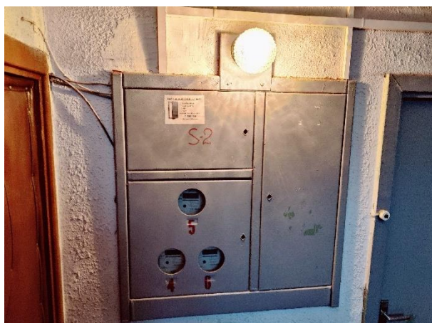
Attēls Nr. 202 Metāla elektrības skapis kāpņu telpā ar viedajiem skaitītājiem un apgaismojumu virs tā
