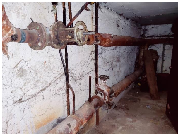
Attēls Nr. 188 Centrālapkures caurules un ventīļi
