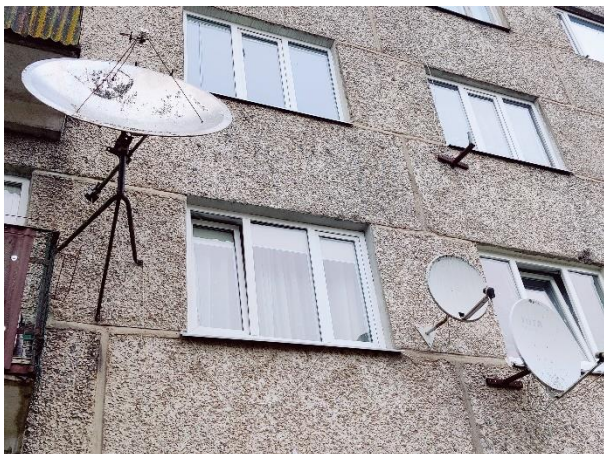
Attēls Nr. 211 Televīzijas satelītšķīvji. Nepieciešams veikt vājstrāvas tīklu un vājstrāvas sistēmu auditu. Nefunkcionējošās sistēmas nepieciešams demontēt!
