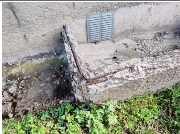
Attēls Nr. 34 Vēsturiskajām pagraba logu atbalstsienām konstatēta lokāla betona erozija (nelielā un dažviet kritiskā apjomā), plaisas, atsegts stiegrojums, betona izdrupumi un sūnu apaugums
