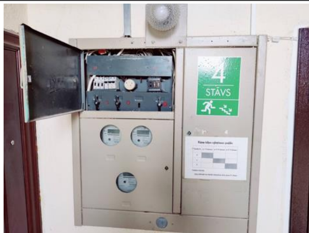
Attēls Nr. 177 Metāla elektrības skapis kāpņu telpā ar viedajiem skaitītājiem un apgaismojumu virs tā
