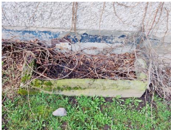
Attēls Nr. 32 Vēsturiskās pagraba logu atbalstsienas tehniski neapmierinošā stāvoklī
