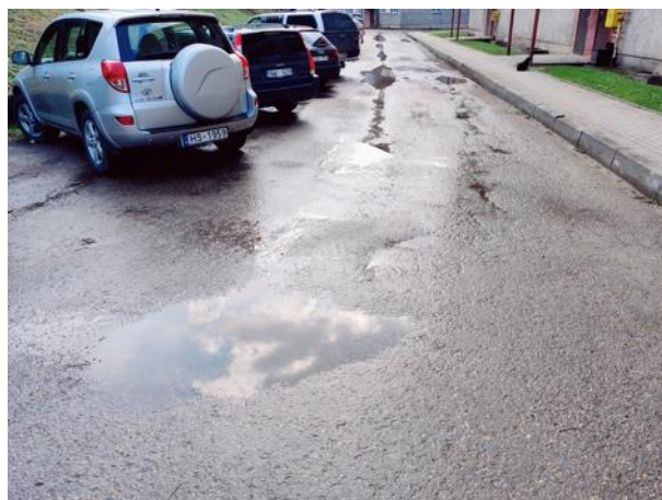
Attēls Nr. 7 Asfalta seguma piebraucamā ceļa kopskats ēkas priekšā. Konstatētas rīses uz ceļa seguma, bedres
