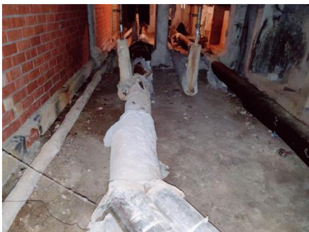
Attēls Nr. 167 Centrālpkures caurules ar veco izolāciju
