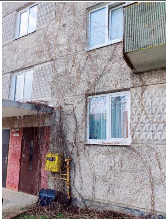
Attēls Nr. 19 Vītenī pie ēkas fasādes, nepieciešams augus likvidēt
