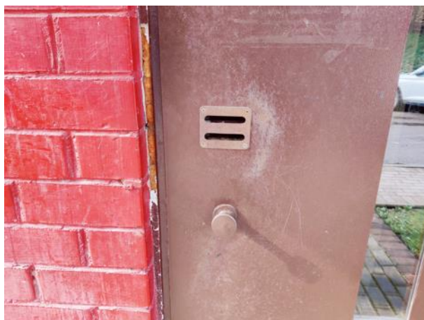
Attēls Nr. 111 Ārdurvīm trūkst kodu atslēga
