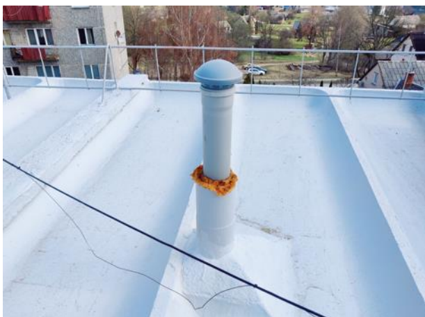
Attēls Nr. 128 Kanalizācijas stāvvadu ventilācijas izvads
