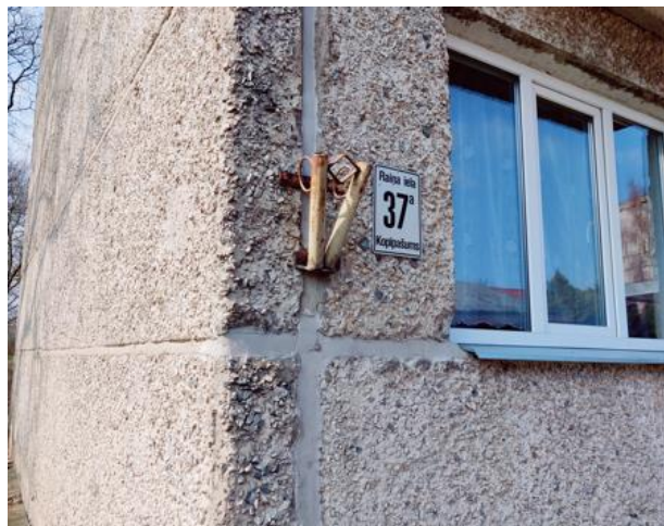
Attēls Nr. 148 Karoga kāta turētāji ir korodējuši
