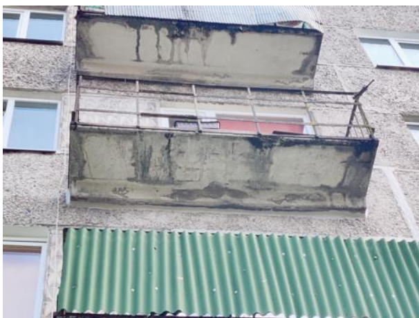
Attēls Nr. 89 Mitruma radīti bojājumi. Nepieciešams veikt bojāto vietu remontu, kur atsegts stiegrojums, lai nepieļautu bojājumu tālāku izplatību
