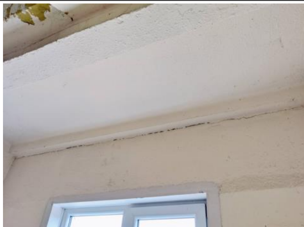
Attēls Nr. 48 Vizuāla rakstura plaisas konstatētas starp ārsienu un kāpņu laukumiņu
