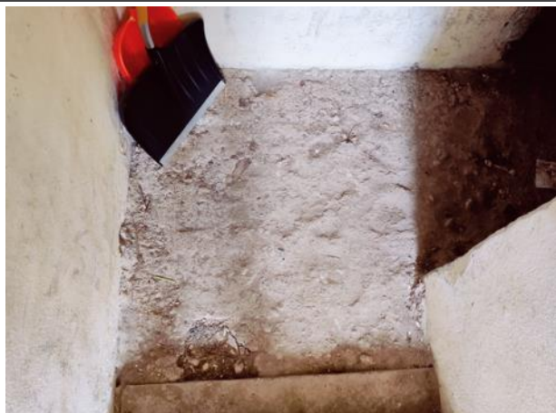
Attēls Nr. 100 Nepieciešams veikt mazus remontdarbus, aizbetonēt bedri
