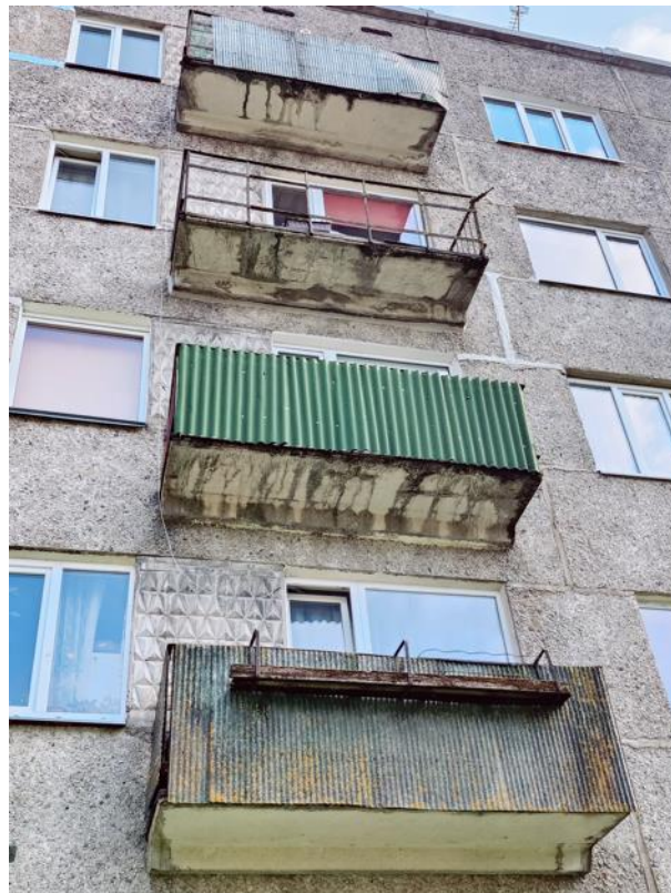
Attēls Nr. 88 Balkonu kopskats, lielākajai daļai kopš ēkas būvēšanas laikiem saglabājušās metāla margas un vēsturiskā viļņoto lokšņu apdare. Vairākiem balkoniem trūkst daļa vai visas vecās apdares plāksnes
