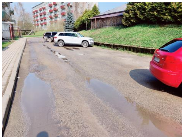
Attēls Nr. 11 Ceļa segums tehniski daļēji apmierinošā stāvoklī. Rekomendējam veikt ceļa remonta darbus, atjaunot ceļa plakniskumu, lai lietusūdens nekrātos uz ceļa
