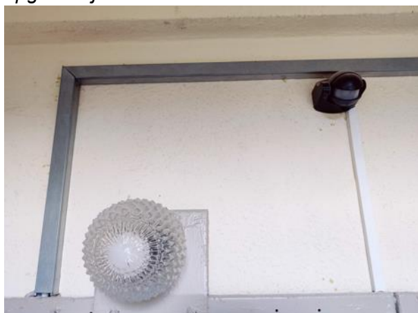
Attēls Nr. 178 Kāpņu telpās uzstādīts sienas apgaismojums ar kustību sensoru
