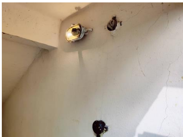
Attēls Nr. 180 Apgaismojums kāpņu telpā
