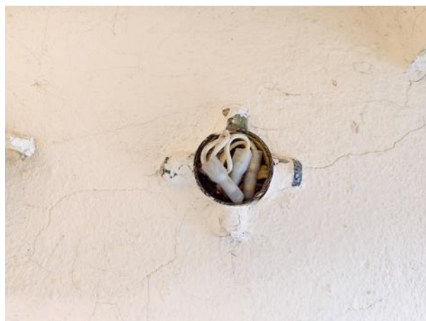
Attēls Nr. 181 Nepieciešams sakārtot un nosegt elektrības vadus
