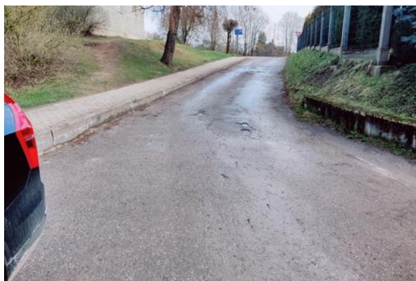
Attēls Nr. 6 Piebraucamais asfaltbetona ceļš ir kopumā tehniski daļēji apmierinošā stāvoklī. Konstatētas rīses, kas veido peļķes lielos apmēros uz ceļa seguma. Berdes, lokālas plaisas
