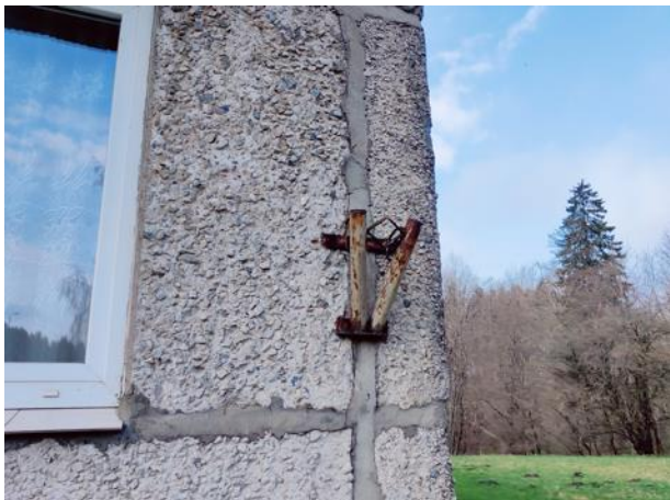
Attēls Nr. 145 Karoga kāta turētāji ir korodējuši
