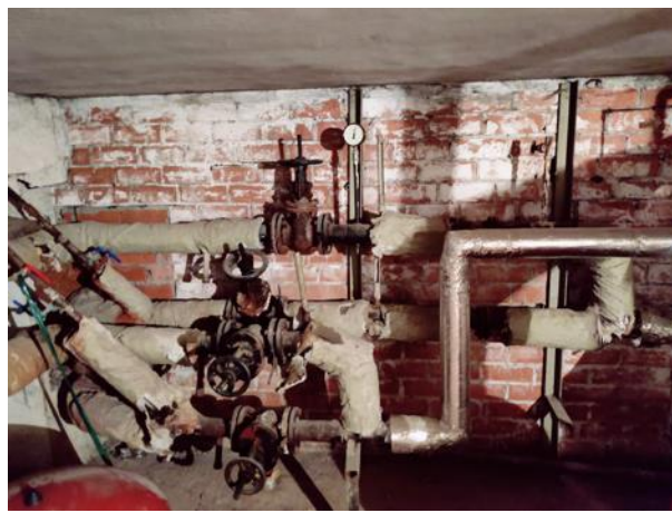
Attēls Nr. 162 Centrālapkures caurules un ventiļi
