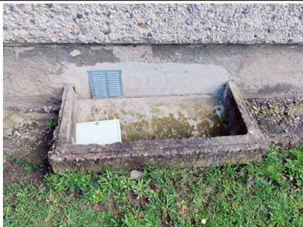
Attēls Nr. 33 Visas gaismas bedres ir aizbetonētas ciet, palikušas tikai dzelzsbetona atbalstsienas neapmierinošā stāvoklī. Rekomendējam veikt atbalstsienu demontāžas darbus un atjaunot cokolu un ēkas apmali
