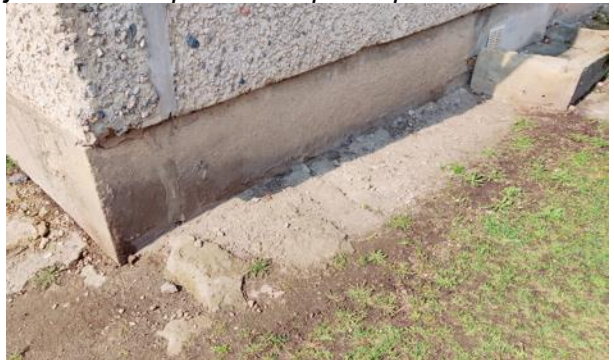
Attēls Nr. 37 Esošajam cokolam lokālās vietās plaisas, apmetuma izdrupumi, mitruma radīti notecējumi. Konstatēta betona erozija, plaisas,
