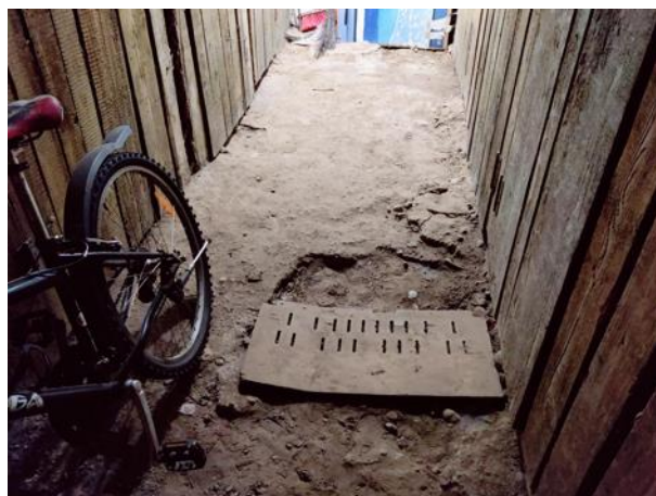
Attēls Nr. 103 Nepieciešams veikt grīdas remontdarbus – aizbetonēt bedri
