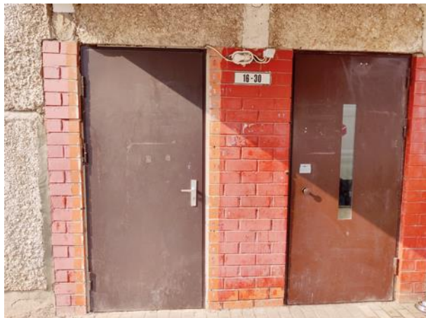
Attēls Nr. 109 Kāpņu telpas un pagraba ārdurvju kopskats. Trūkst kodu atslēgas, mehāniski bojājumi un lokāla korozija
