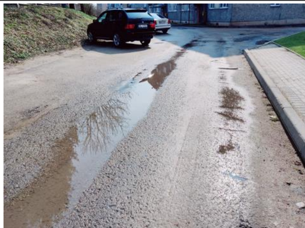
Attēls Nr. 9 Asfalta seguma piebraucamā ceļa kopskats ēkas priekšā. Konstatētas rīses uz ceļa seguma, bedres
