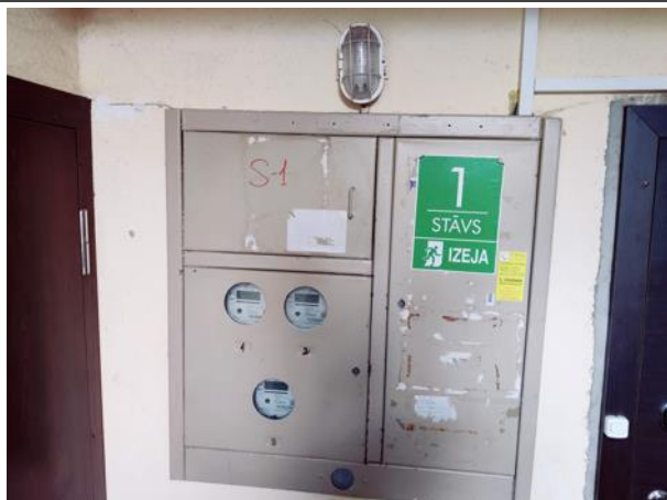
Attēls Nr. 176 Metāla elektrības skapis kāpņu telpā ar viedajiem skaitītājiem un apgaismojumu virs tā
