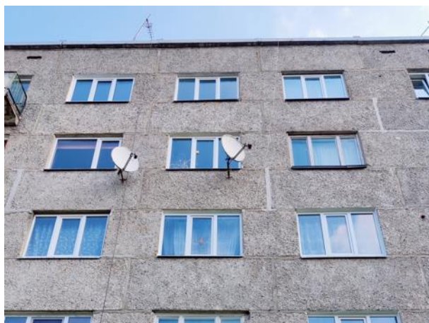
Attēls Nr. 119 Gandrīz visiem ēkas dzīvokļiem uzstādīti mūsdienīgi PVC konstrukciju stikla pakešu logi
