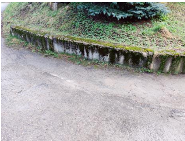
Attēls Nr. 29 Dzelzsbetona bloku mūra atbalstsiena. Tehniski neapmierinošā stāvoklī. Rekomendējam veikt remontdarbus, notīrīt plaknes no sūnām un atjaunot šuvajumu
