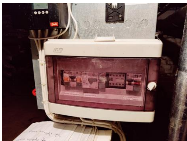
Attēls Nr. 160 Drošinātāju skapis siltummezglā
