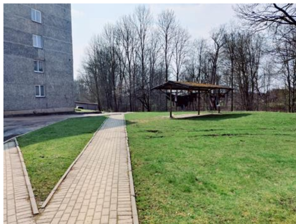
Attēls Nr. 22 Otra nojume veļas žāvēšanai. Kopumā tehniski apmierinošā stāvoklī, rekomendējam veikt metāla konstrukciju aizsargslāņa atjaunošanu un ilgtermiņā izskatīt iespēju azbestbetona lokšņu jumta segumu nomainīt pret videi un cilvēka veselībai nekaitīgu materiālu
