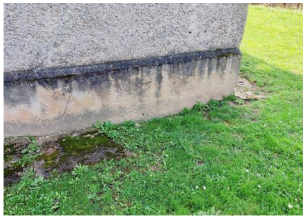
Attēls Nr. 36 Mitruma radīti bojājumi / notecējumi. Lokālos posmos ap ēku trūkst ēkas apmales
