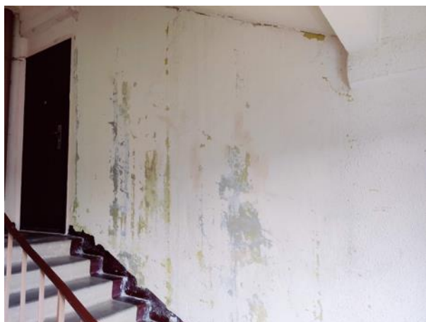
Attēls Nr. 141 Mehāniski iekšējās apdares bojājumi
