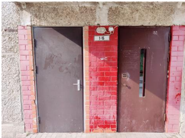
Attēls Nr. 108 Kāpņu telpas un pagraba ārdurvju kopskats. Trūkst kodu atslēgas, mehāniski bojājumi un lokāla korozija
