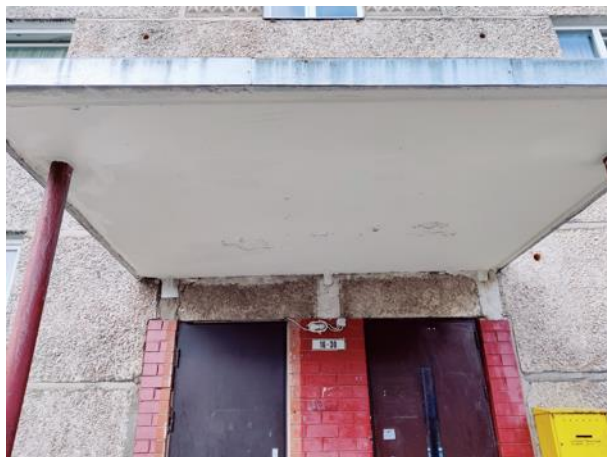
Attēls Nr. 84 Dzelzsbetona plātnes jumtiņa kopskats no apakšpuses. Mitruma radīti bojājumi, lobās nost krāsas
