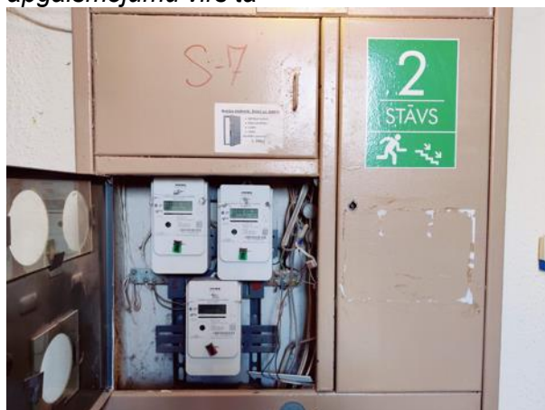
Attēls Nr. 179 Metāla elektrības skapis kāpņu telpā ar viedajiem skaitītājiem
