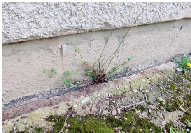
Attēls Nr. 35 Veģetatīvi apaugumi. Ēkas apmale sliktā stāvoklī. Nepieciešams ierīkot jaunu ēkas apmali ar slīpumu prom no ēkas
