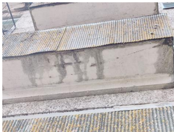
Attēls Nr. 90 Atsevišķu balkonu apakšām nepieciešams veikt bojāto vietu remontu, kur atsegts stiegrojums, lai nepieļautu bojājumu tālāku izplatību
