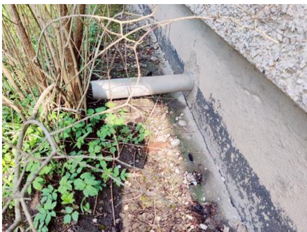
Attēls Nr. 27 Nedrīst stādīt krūmus tik tuvu pie ēkas apmales un pamatiem. Nevar pareizi novadīt lietusūdeni, viss tek atpakaļ uz pamatiem. Krūmu nepieciešams izrakt un pārstādīt tālāk. Pagarināt lietus noteku
