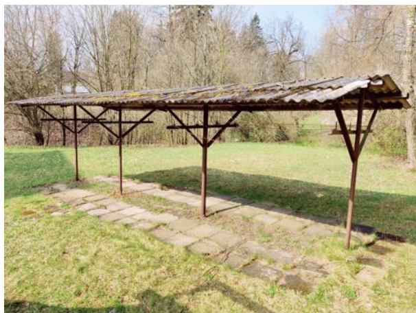
Attēls Nr. 21 Nojume veļas žāvēšanai. Kopumā tehniski apmierinošā stāvoklī, rekomendējam veikt metāla konstrukciju aizsargslāņa atjaunošanu un ilgtermiņā izskatīt iespēju azbestbetona lokšņu jumta segumu nomainīt pret videi un cilvēka veselībai nekaitīgu materiālu
