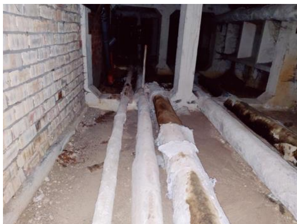
Attēls Nr. 168 Centrālpkures caurules ar veco izolāciju
