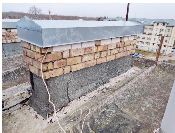
Attēls Nr. 142 Dabīgās ventilācijas izvadkanāls uz ēkas jumta. Uzstādītas skārda nosegecpures
