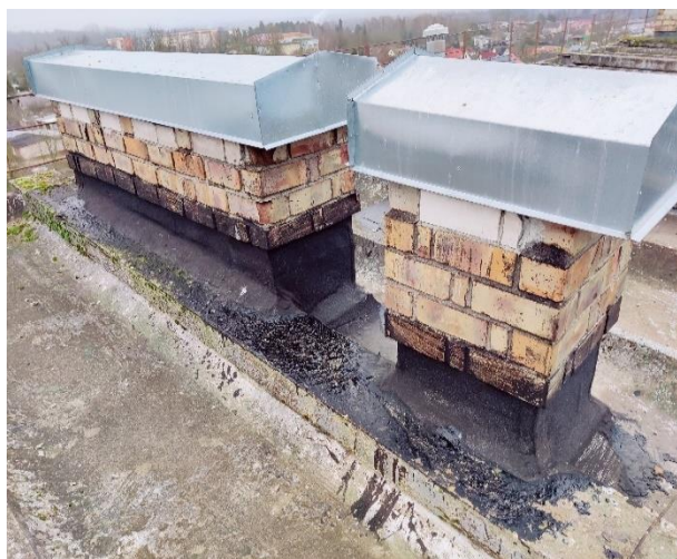
Attēls Nr. 144 Dabīgās ventilācijas izvadkanālu kopskats
