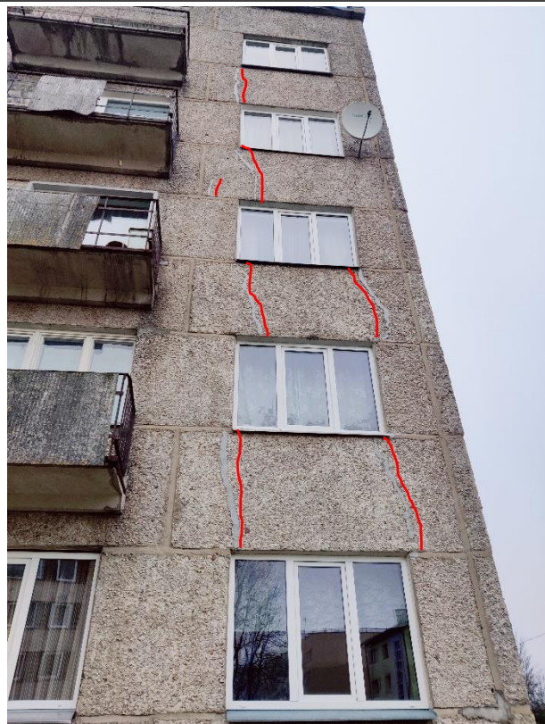
Attēls Nr. 162 Plaisu kopskats saliekamā dzelzsbetona paneļos 1.kāpņu telpas zonā
