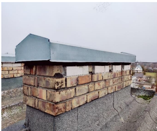
Attēls Nr. 145 Daļai izvadkanālu esošā sprauga tik un tā ir par lielu un putni var iekļūt!
