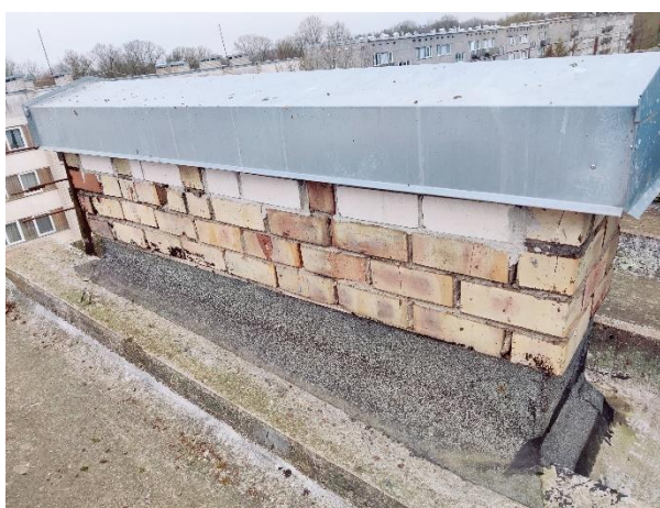
Attēls Nr. 143 Dabīgās ventilācijas izvadkanāls uz ēkas jumta. Brīvie atvērumi daļēji aizmūrēti, lai samazinātu iespēju putniem iekļūt iekštelpās
