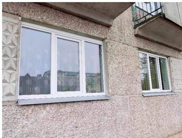
Attēls Nr. 137 Gandrīz visiem ēkas dzīvokļiem uzstādīti mūsdienīgi PVC konstrukciju stikla pakešu logi
