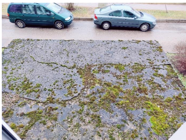
Attēls Nr. 102 Jumtiņam liels organiskais apaugums. To nepieciešams attīrīt un uzklāt hidroizolējošu seguma materiālu
