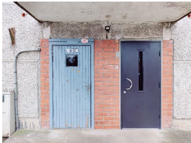
Attēls Nr. 125 2.kāpņu telpas ārdurvju kopskats. Pagraba koka konstrukcijas durvis morāli novecojušas
