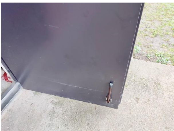
Attēls Nr. 128 Visām metāla ārdurvīm uzstādītas kājiņas durvju fiksēšanai atvērtā stāvoklī
