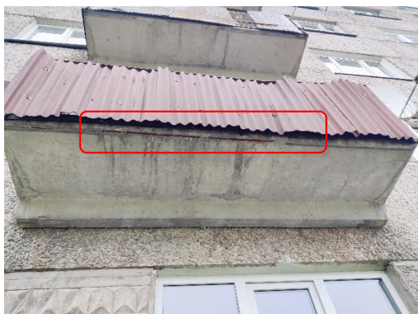
Attēls Nr. 95 Atsevišķu balkonu apakšām nepieciešams veikt bojāto vietu remontu, kur atsegts stiebrojums, lai nepieļautu bojājumu tālāku izplatību
