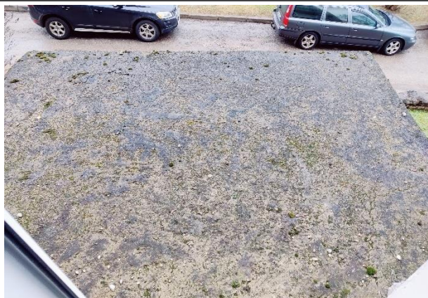
Attēls Nr. 99 Jumtiņa kopskats no augšas. Trūkst hidroizolējošs seguma materiāls
