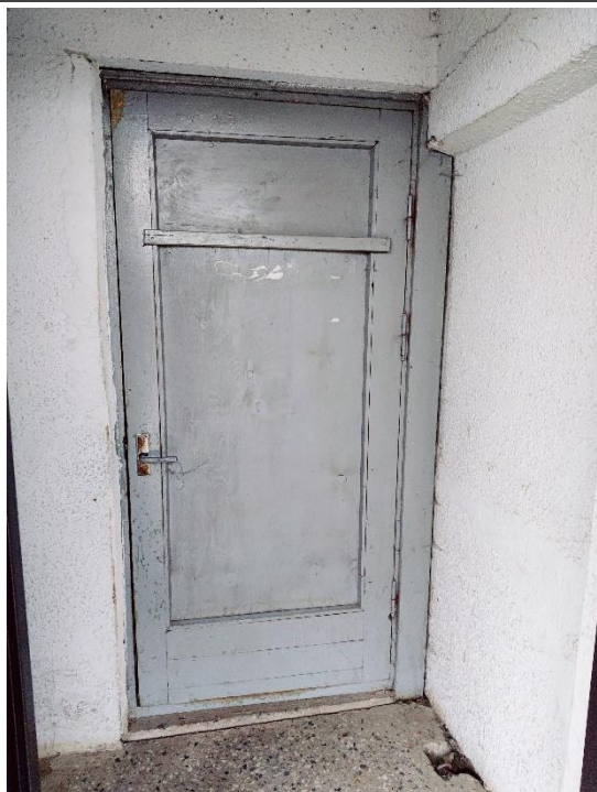
Attēls Nr. 130 Koplietošanas kāpņu telpās ir saglabājušās vecās koka konstrukcijas iekšdurvis. Tās ir morāli novecojušas un nav energoefektīvas
