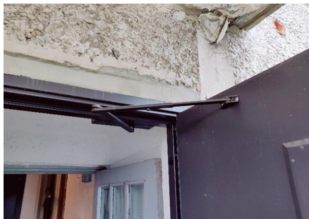
Attēls Nr. 127 Visām metāla ārdurvīm uzstādīti aizvērēji
