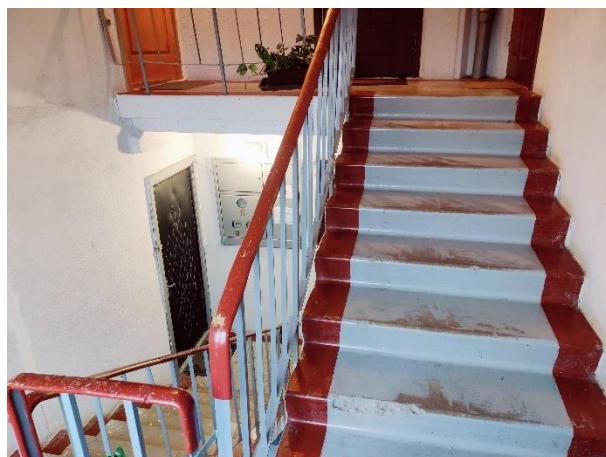
Attēls Nr. 111 Saliekamās dzelzsbetona kāpnes ar metāla margām un gumijotu lenteri. Konstatēti lokāli krāsas nodilumi un betona izdrupumi
