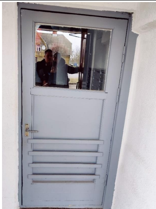
Attēls Nr. 131 Koplietošanas kāpņu telpās ir saglabājušās vecās koka konstrukcijas iekšdurvis. Tās ir morāli novecojušas un nav energoefektīvas
