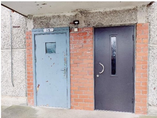
Attēls Nr. 124 1.kāpņu telpas ārdurvju kopskats. Pagraba koka konstrukcijas durvis morāli novecojušas
