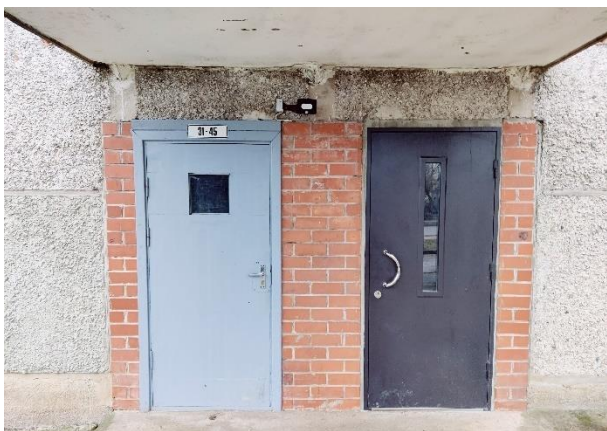
Attēls Nr. 126 3.kāpņu telpas ārdurvju kopskats. Pagraba koka konstrukcijas durvis morāli novecojušas
