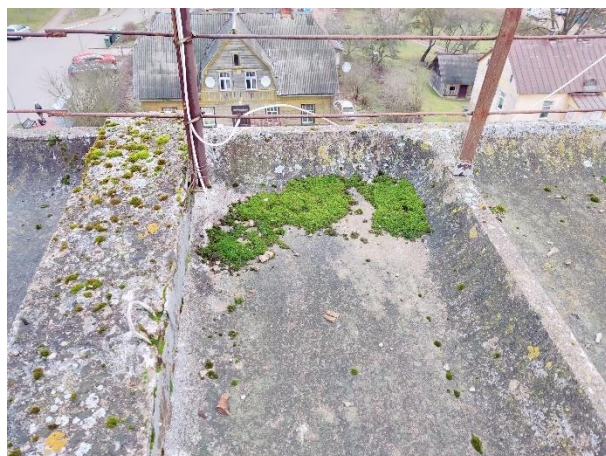
Attēls Nr. 81 Jumta konstrukcijas nepieciešams regulāri attīrīt no sūnu apauguma
