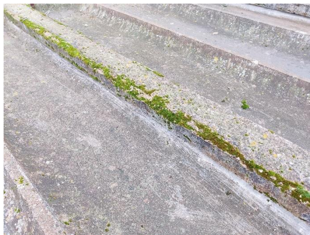
Attēls Nr. 79 Jumta dzelzsbetona paneļiem sākušies betona erozijas procesi. Vietām liels organiskais apaugums
