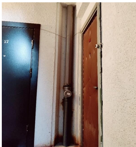
Attēls Nr. 87 Lietusūdens kanalizācijas stāvvadi no PVC materiāla caurulēm
