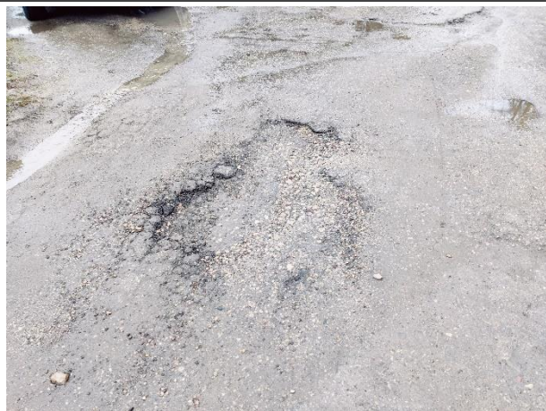
Attēls Nr. 9 Asfalts saplaisājis, vietām iziris
