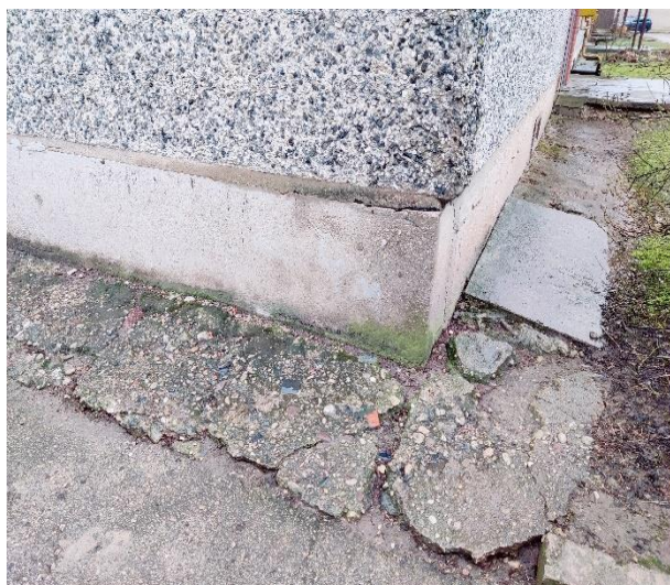
Attēls Nr. 32 No ārpusē cokola līmenī nav veikta virsmas apstrāde. Betona apmale saplaisājusi un nodrupusi
