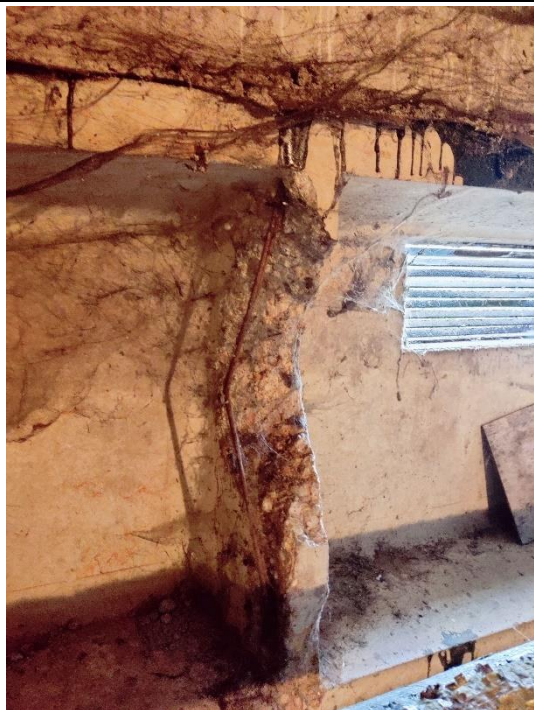
Attēls Nr. 30 Bojājuma tuvplāns. Nodauzīts betona gabals, stiegrojums salocīts
