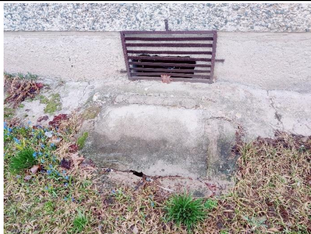
Attēls Nr. 35 Aizbetonētas vēsturiskas bedres pie ventilācijas atvērumiem pagrabos
