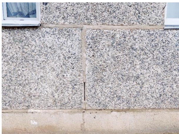
Attēls Nr. 55 Atsevišķas fasādes paneļu šuves nav hermētiskas. Šādus tukšumus nepieciešams aizpildīt
