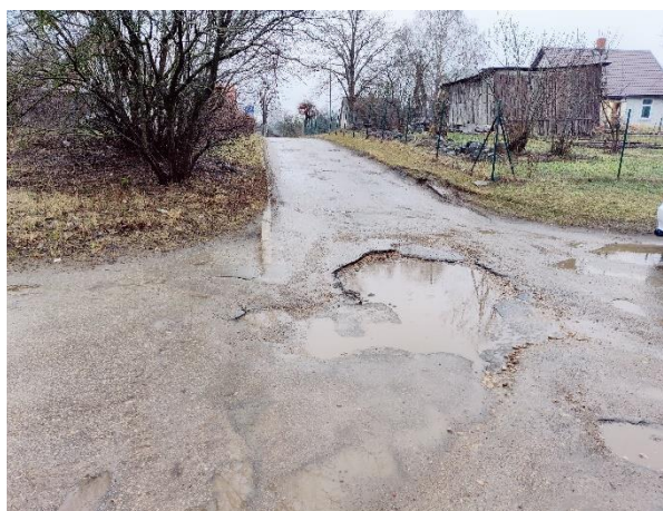
Attēls Nr. 5 Asfalta segumā vairākās vietās lielas bedres
