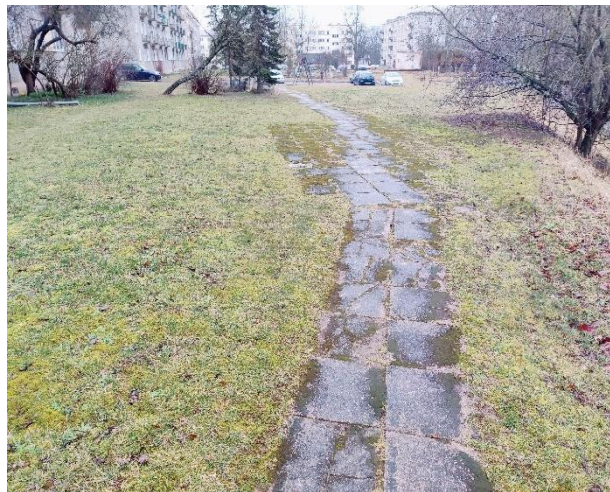
Attēls Nr. 15 Betona plākšņu segums stipri apsūņojis ietvei
