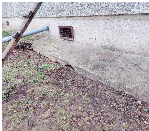
Attēls Nr. 33 Vietām atsegts cokola stiegrojums. Tukšumi zem betona plātnēm
