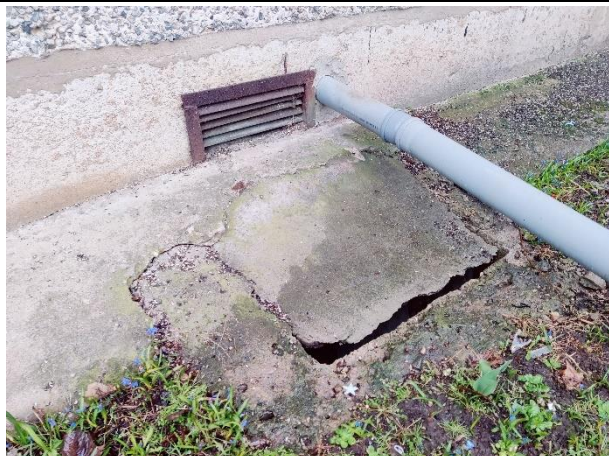
Attēls Nr. 34 Aizbetonētas vēsturiskas bedres pie ventilācijas atvērumiem pagrabos
