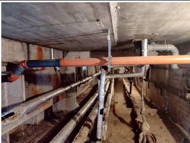
Attēls Nr. 82 Lietusūdens kanalizācijas guļvadi pagrabā no PVC materiāla caurulēm
