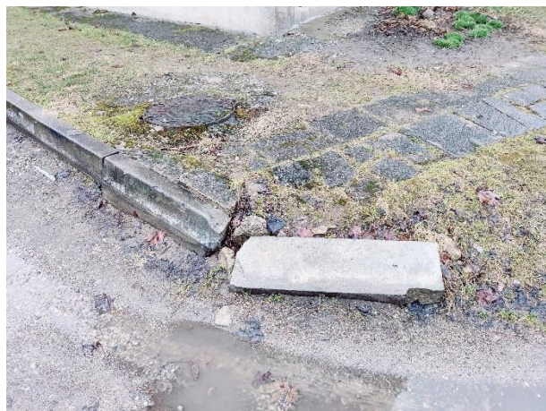
Attēls Nr. 13 Betona bortakmeņi mehāniski bojāti un izkustināti no vietas
