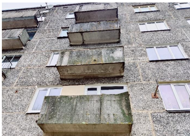
Attēls Nr. 89 Dzelzsbetona paneļi balkoniem ir apmierinošā stāvoklī
