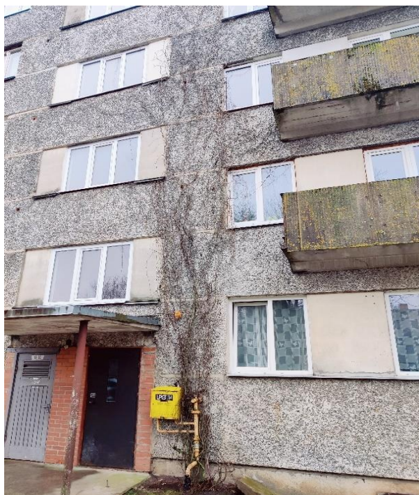
Attēls Nr. 22 Vītēnaugs uz ēkas fasādes – To nepieciešams likvidēt!
