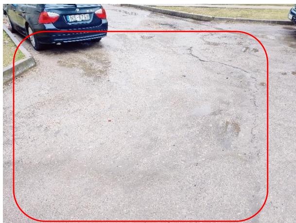
Attēls Nr. 10 Bildē grūti saskatāms, bet asfalta segums pilnībā sairis lielā laukumā
