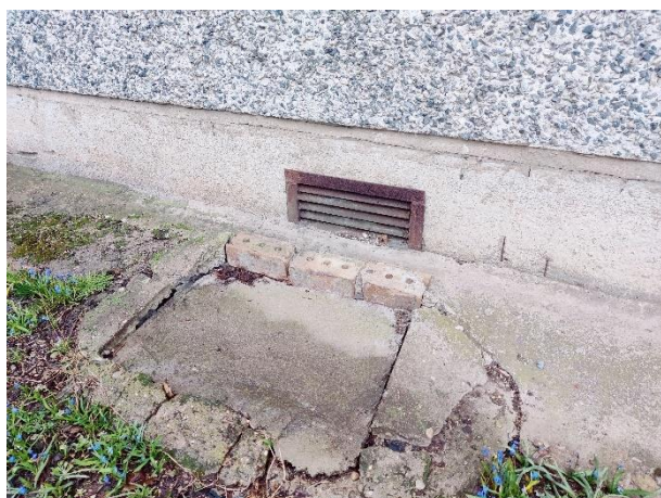
Attēls Nr. 36 Aizbetonētas vēsturiskas bedres pie ventilācijas atvērumiem pagrabos
