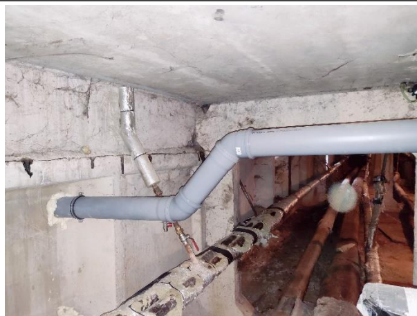
Attēls Nr. 83 Lietusūdens kanalizācijas guļvadi pagrabā no PVC materiāla caurulēm
