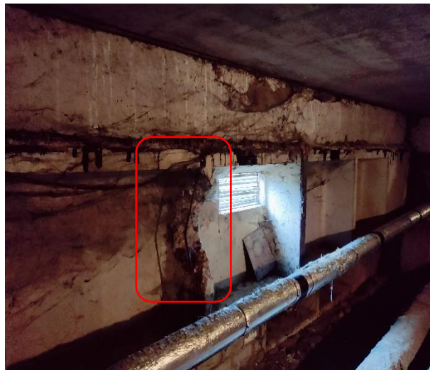
Attēls Nr. 29 Pamatu dzelzsbetona paneļa, ar pagraba logu, kopskats. Paneļa ribai mehānisks defekts
