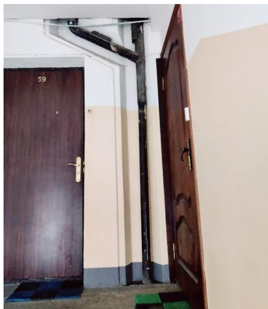
Attēls Nr. 81 1., 2. un 4.kāpņu telpā saglabājušies vecie čuguna cauruļu lietusi ūdens stāvvadi
