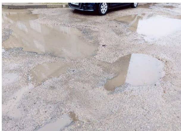
Attēls Nr. 6 Asfalta segumā vairākās vietās lielas bedres
