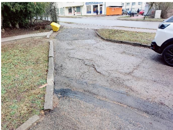
Attēls Nr. 4 Asfalta seguma iebrauktuve no Raiņa ielas puses. Asfalta segums saplaisājis, ar iesēdumiem
