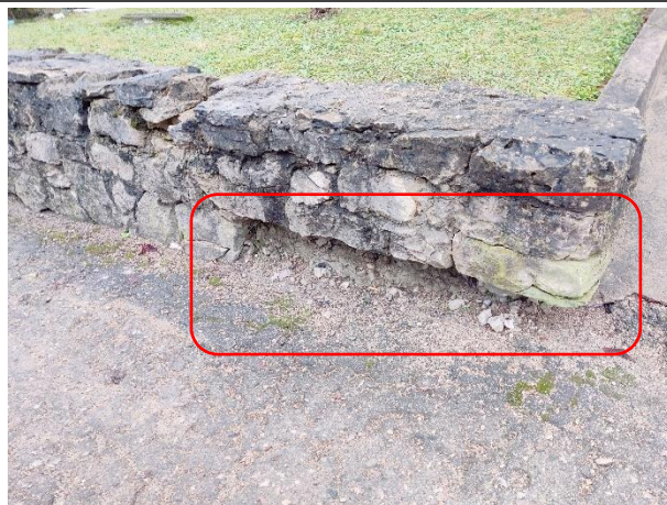
Attēls Nr. 32 Akmens mūrējuma apakšējā daļa izdrupusi. Mūrējums nav stabils šajā posmā!
