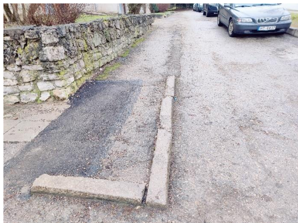
Attēls Nr. 17 Asfalta seguma ietves posms 1.kāpņu telpas galā. Bortakmeņi apdrupuši. Segums iepriekš lokāli remontēts
