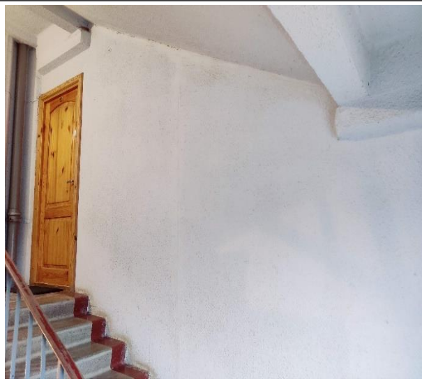
Attēls Nr. 52 Kāpņu telpas nesošās šķērssienas kopskats. 1.-2.stāvu līmenī plaisas šuvēs netika konstatētas
