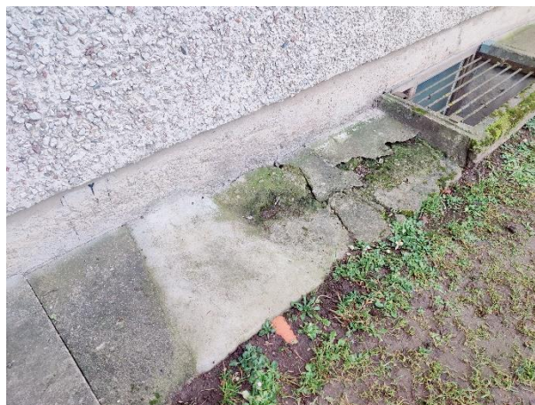
Attēls Nr. 46 Caur pamatiem no jauna izbūvēta PVC lietussūdens novadcaurule, lokāli atjaunota betona apmale. Blakus posms sliktā stāvoklī
