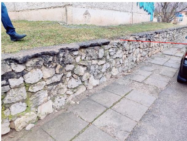
Attēls Nr. 29 Atbalstsienas kopskats. Vietām mūrjava izdrupusi. Betona aizsargcepure iztrūkst lokāli
