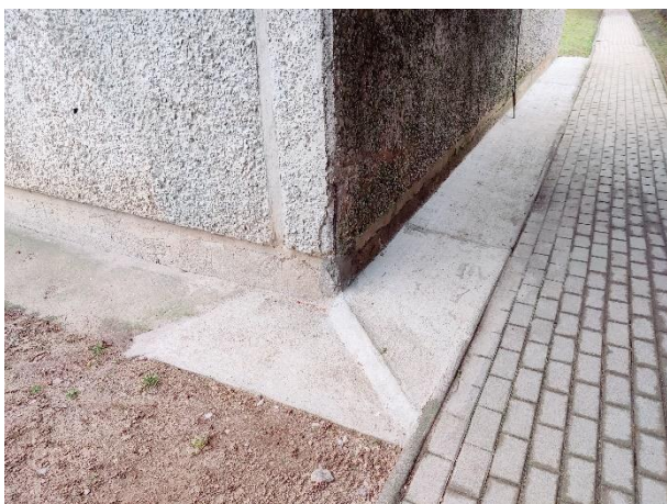
Attēls Nr. 41 Pie gala sienas betona apmale atjaunota pilnībā, bet pamati nav nosiltināti, nav ierīkota vertikālā hidroizolācija
