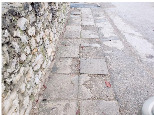
Attēls Nr. 16 Betona plākšņu ietves kopskats gar atbalstsienu. Vairākas plātnes pilnībā sairušas. Nepieciešams veikt to nomaiņu!
