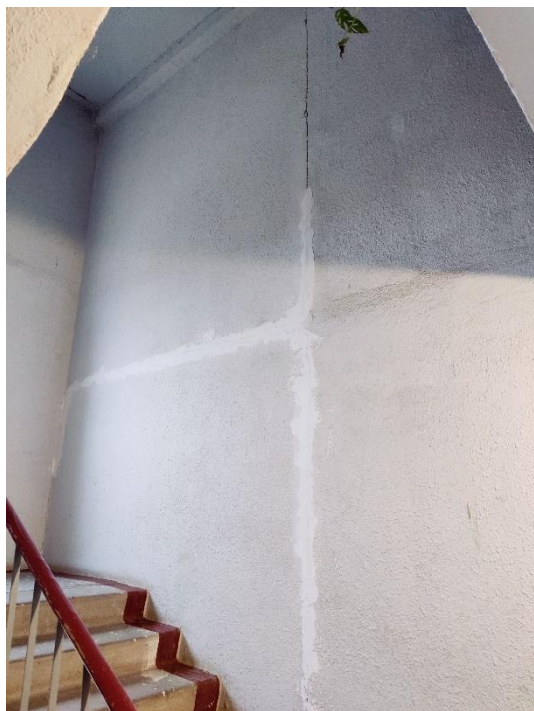
Attēls Nr. 49 Daļēji aizdarītas plaisas kāpņu telpas nesošajās šķērssienās
