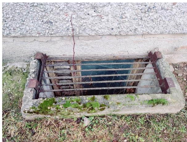
Attēls Nr. 34 Galvenokārt visām atbalstsienām konstatēta betona virsmas erozija. Sūnu apaugums
