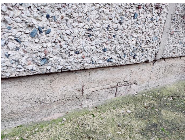
Attēls Nr. 39 No ārpusē cokola līmenī nav veikta virsmas apstrāde. Vietām atsegts pamatu stiebrojums
