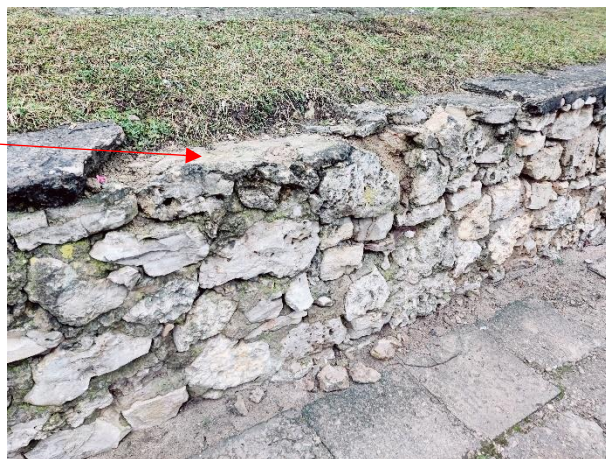
Attēls Nr. 30 Bojājuma tuvplāns. Nepieciešams veikt atbalstsienas remontu.
