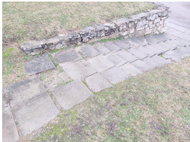
Attēls Nr. 13 Betona plākšņu pakāpienu kopskats. Atsevišķas plāksnes pilnībā izdrupušas
