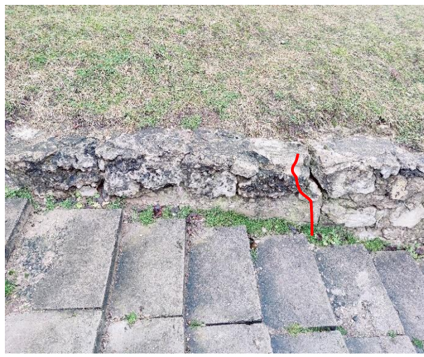
Attēls Nr. 28 Dolomītakmeņu atbalstsiena gar ēkas gala fasādi. Konstatēta plaisa mūrī
