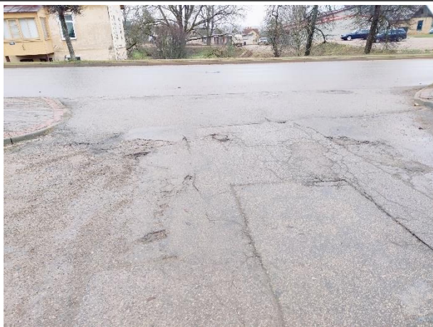
Attēls Nr. 7 Asfalta seguma izbrauktuve uz Raiņa ielu. Segums sadrupis, veidojas bedres, iepriekš jau veikti lokāli remontu
