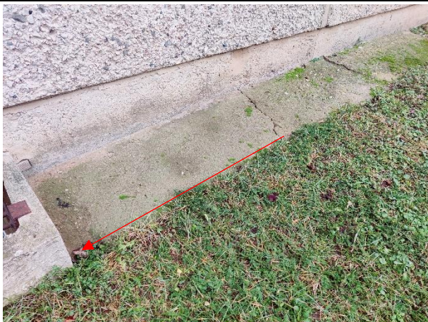
Attēls Nr. 43 Betona apmale saplaisājusī, uz pagraba loga pusi tā nedaudz iegrimusi
