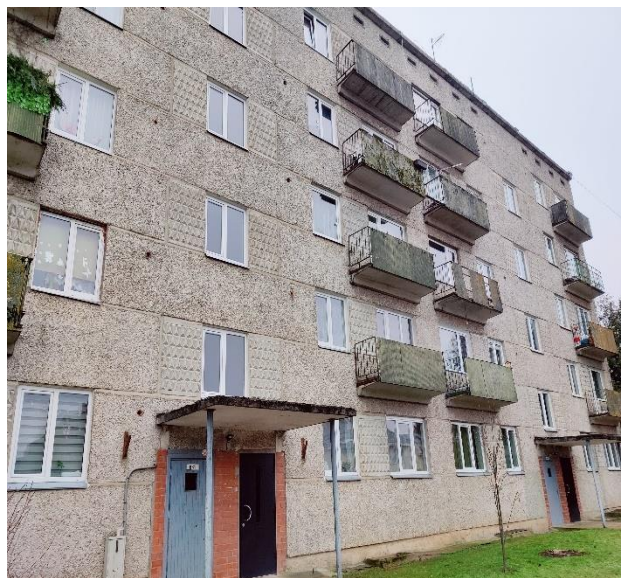
Attēls Nr. 54 Nesošās norobežojošās konstrukcijas veidotas no saliekamā dzelzsbetona paneļiem. 1.kāpņu telpas stūrī paneļos konstatētas plaisas, kuras 2023.g. aizdarītas ar Bostik P590. Konstatētās plaisas ekspluatācijas draudus nerada.
