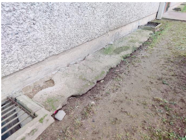
Attēls Nr. 45 Betona apmale daļēji apmierinošā stāvoklī, betons erodējies un nodrupis
