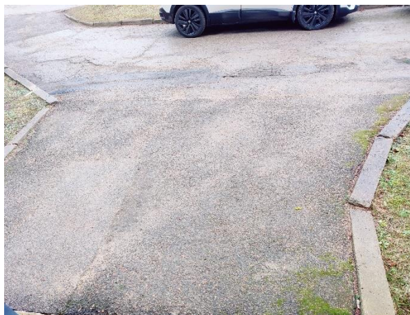
Attēls Nr. 5 Asfalta seguma laukums kāpņu telpu priekšā
