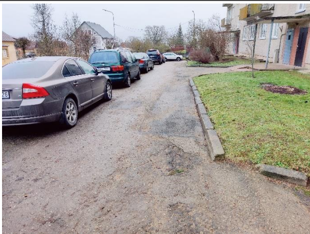
Attēls Nr. 6 Asfalta seguma piebraucamā ceļa kopskats ēkas priekšā. Bortakmeņi vietām izdrupuši
