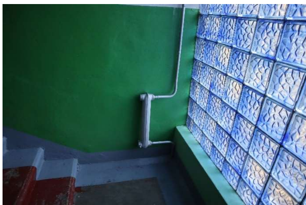
Čuguna radiators kāpņu telpā
