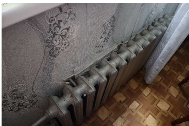
Čuguna radiators dzīvoklī
