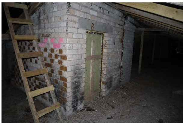
Kāpņu telpas siena pret bēniņiem
