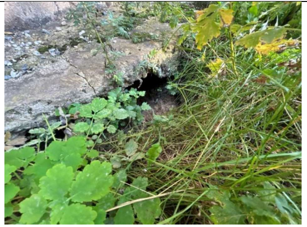
4.1.10. att. Vairākās vietās betona aizsargapmales nodrupušas, saplaisājušas, lokāli ir izskalojumiem zem aizsargapmales
