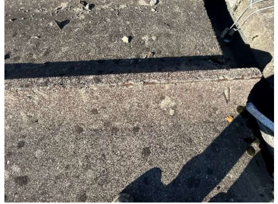
4.8.2. att. Vairākās vietās pārseguma plātnēm nodrupumi, atsegti un korodējis stiegrojums
