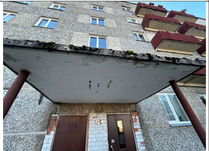
4.19.2. att. Ķieģeļu mūra erozija pie ārdurvīm
