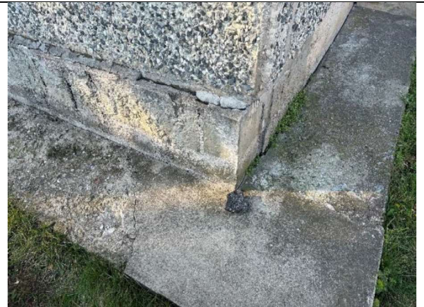
4.1.12. att. Vairākās vietās cokola apdares un bojājumi. Vietās, kur pamata konstrukcija ir izvirzīta bojāts slīpumu veidojošais betona nosegelements nokrišņu novadīšanai.
