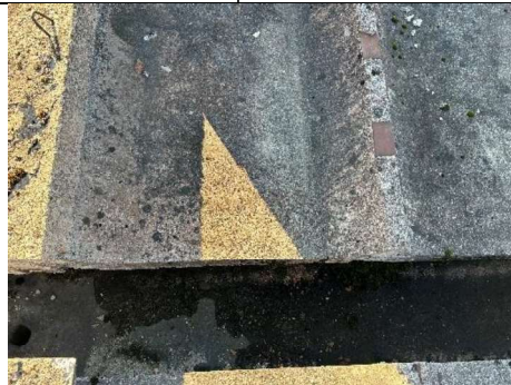
4.8.13. att. Mitruma uzkrāšanās pazīme tekņē, kas liecina par nepietiekamu slīpumu šajās teknes daļās
