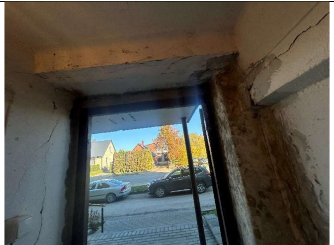
4.9.9. att. Mitruma radīti bojājumi ārējai iespējams nehermētiskas ieejas jūtīga enkurojuma vietas dēļ
