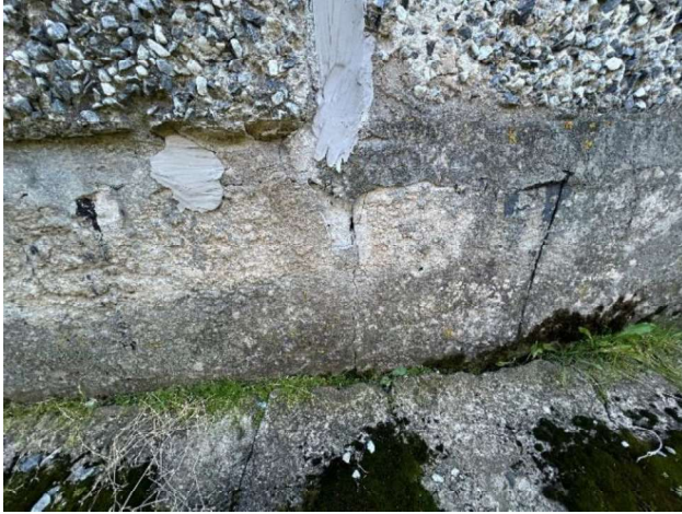
4.1.7. att. Vairākās vietās plaisas pamata konstrukcijas šuvju vietās
