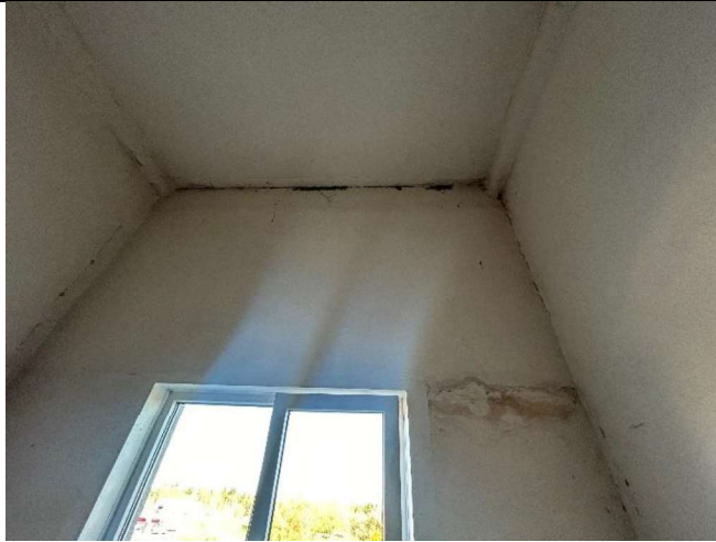
4.18.7. att. Plaisas un mitruma radīti bojājumi ārsienas paneļu šuvju vietās
