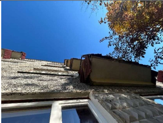
4.9.5. att. Daļēji atdalījusies balkona apdares loksne
