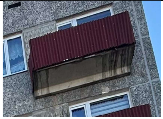
4.9.6. att. Vārākās vietās, kur balkonu konstrukcija bojāta pa perimetru, sevišķi pēdējā stāva balkoniem novērojams, ka ūdens tek pa balkona apakšu līdz pat fasādei
