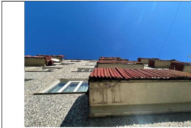
4.9.3. att. Lokāli nodrupumi, atsegts stiegrojums un plaisas šajās vietās konstrukcijas mitruma piesātinātas
