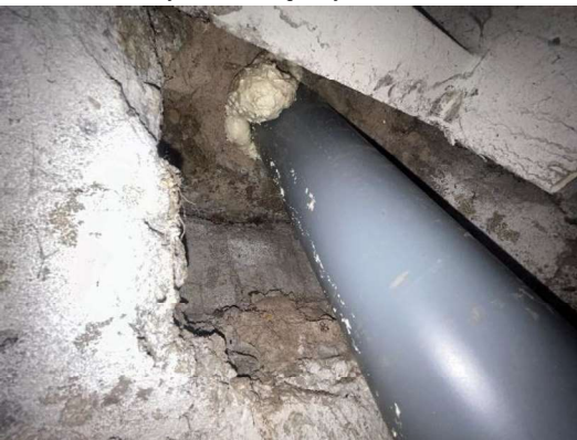
4.6.5. att. Pagraba griesti - inženierkomunikāciju šķērsojuma vieta aizpildījumam izmantojot montāžas putas
