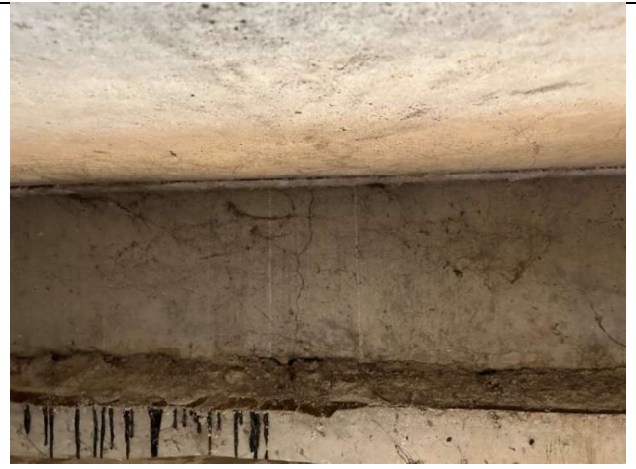
4.1.4. att. Vairākās vietās nelielas plaisas ārsienu paneļu konstrukcijā no pagraba puses virs logailām
