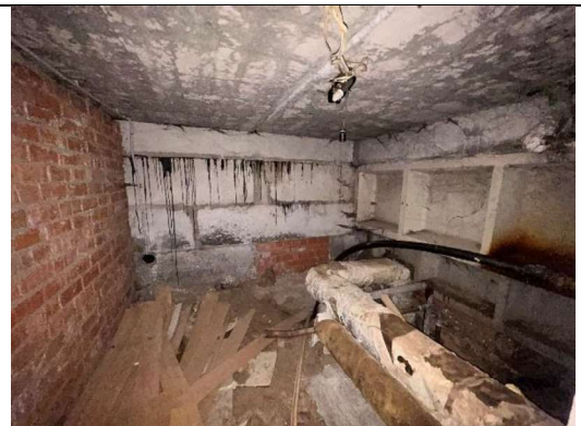
5.2.2. att. Siltumtrases ievads ēkas pagrabā no katlu mājas
