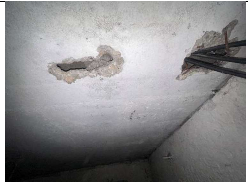
4.6.4. att. Pagraba griesti - inženierkomunikāciju šķērsojuma vieta bez aizpildījuma, ar atsegtu, deformētu un korodējošu stiegrojumu
