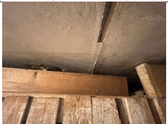
4.6.6. att. Pagraba griesti – atdalījies cementa aizpildījums pagraba griestu paneļu šuvju vietā
