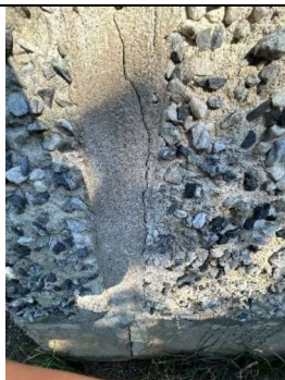
4.2.1. att. Vairākās vietās plaisas ārsienu paneļu šuvju vietās
