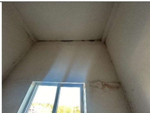
4.2.3. att. Vairākās vietās kāpņu telpās novērojamas plaisas starpsienu un starpsienu, mitruma radīti bojājumi apdarē ārsienas paneļu šuvju vietā
