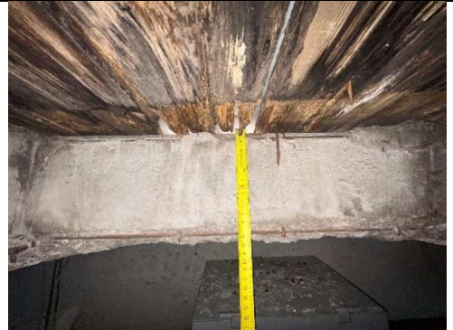
4.8.10. att. Nodrupumi un atsegts, korodējis stiebrojums pārseguma plātnei. Jumta lūka ar satrupējušiem koka elementiem, bez fiksācijas elementiem
