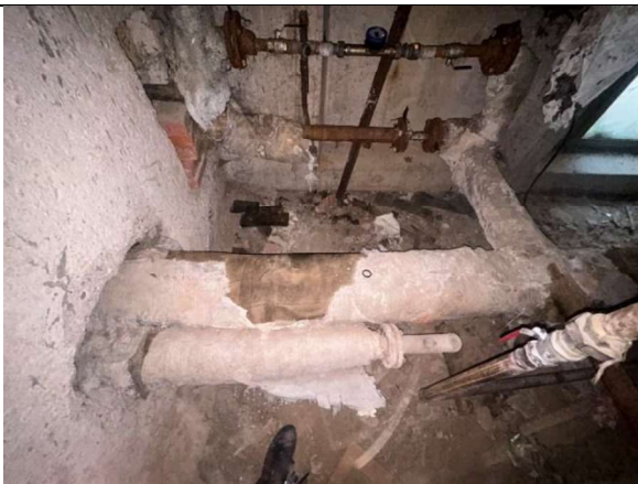
5.1.4. att. Aukstā ūdens cauruļu nesiltinātā daļa un siltinātā daļa ar oriģinālo siltumizolācijas risinājumu
