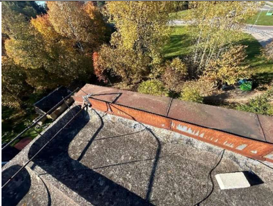
4.8.3. att. Korodējis parapeta nosegelements
