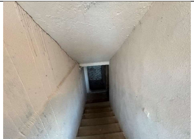
4.10.2. att. Vairākās vietās spraugas starp kāpņu laidiem un starpsienām
