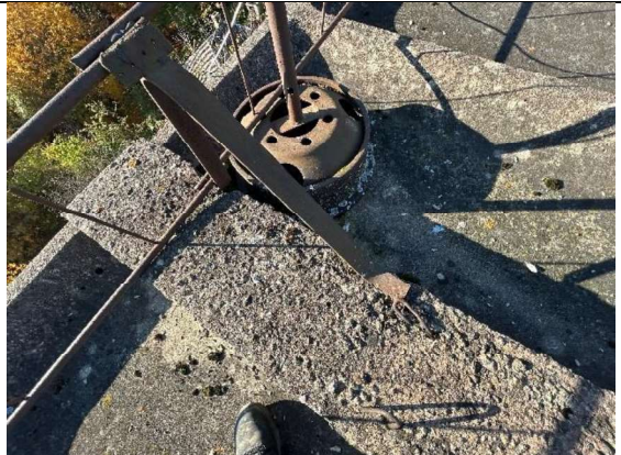
4.8.4. att. Korodējusi, metināta metāla apmale pa jumta garenass perimetru
