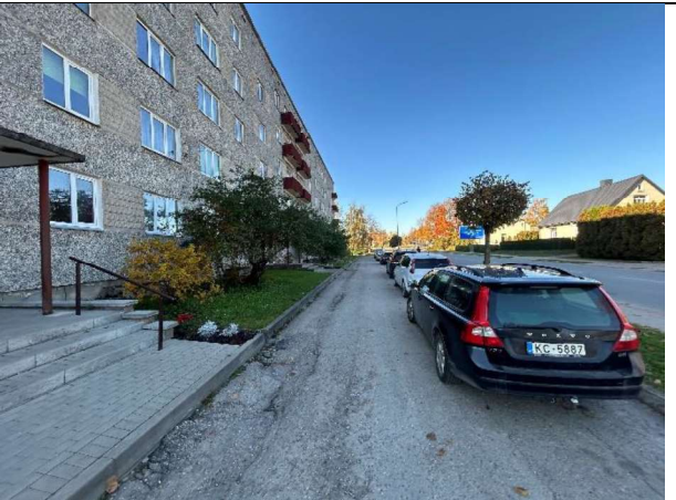
3.1.5. att. Ziemeļu fasādes asfalta seguma bojājumi un bruģakmens pieslēgums kāpņu telpas ieejas platformai
