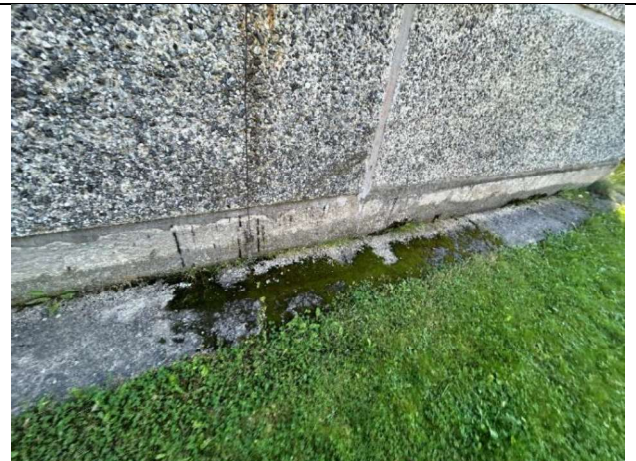
4.1.6. att. Vairākās vietās veģetatīvi betona aizsargapmales apaugumi
