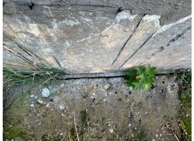
4.1.8. att. Vairākās vietās spraugas gar betona aizsargapmali un pamata konstrukciju
