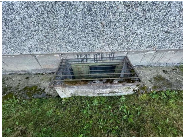
4.1.5. att. Pagraba logailas konstrukcija – vairākās vietās bojāta betona apmale ar atsegtu, korodējušu stieģrojumu.
