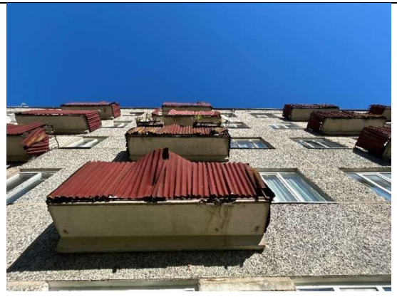
4.9.4. att. Lokāli nodrupumi, atsegts stiegrojums un plaisas šajās vietās konstrukcijas mitruma piesātinātas
