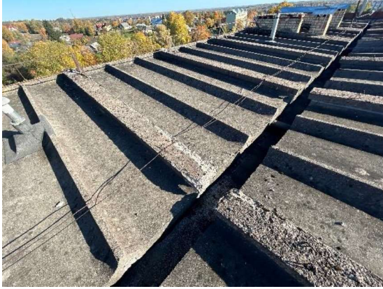
4.8.1. att. Riboto dzelzsbetona plātņu segums un betona nosegelementi virs panelu savienojuma vietām - konstrukcijas ar nodrupumiem vairākās vietās un atsegtu, korelējušu stiegrojumu
