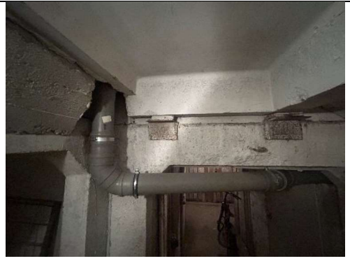
4.8.12. att. Notekcaurule ēkas pagrabstāvā
