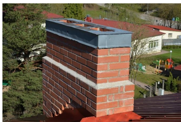
4.16.2.att. Ventilācijas izvadi
