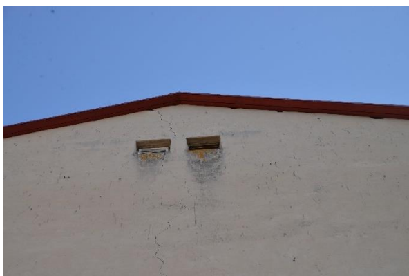
4.2.7.att. Lokālas plaisas, lokāla mūra destrukcija
