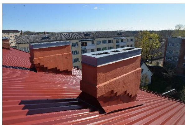
4.16.1.att. Ventilācijas izvadi
