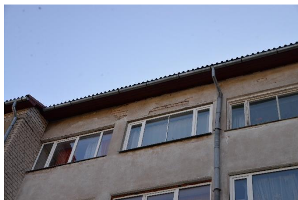
4.2.8.att. Mitruma piesātinājums ar lokālu destrukciju
