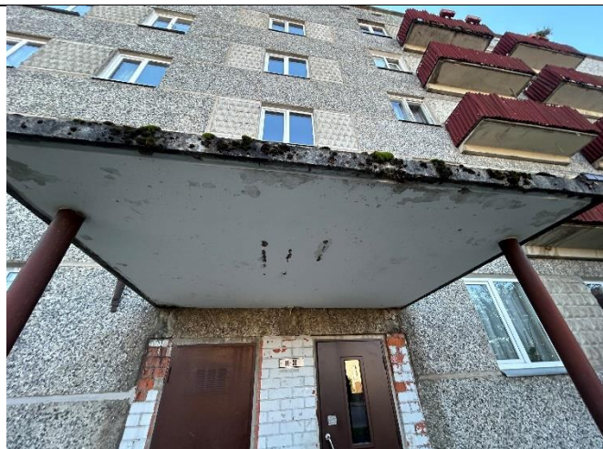
4.19.2. att. Ķieģeļu mūra erozija pie ārdurvīm
