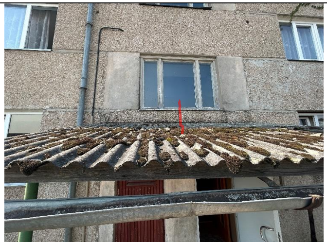
4.2.8. att. Vertikāla plaisa plaisa panelī zem kāpņu telpas loga
