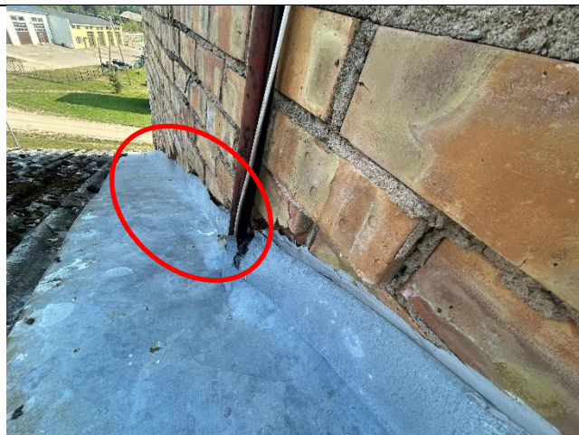
4.8.6. att. Skārda lokšņu pieslēgums izvadkanālam, savienojuma vieta hermetizēta tikai daļēji
