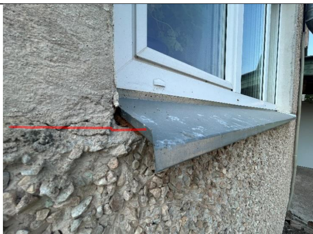
4.2.4. att. Plaisas ārsienu paneļu savienojuma vietās
