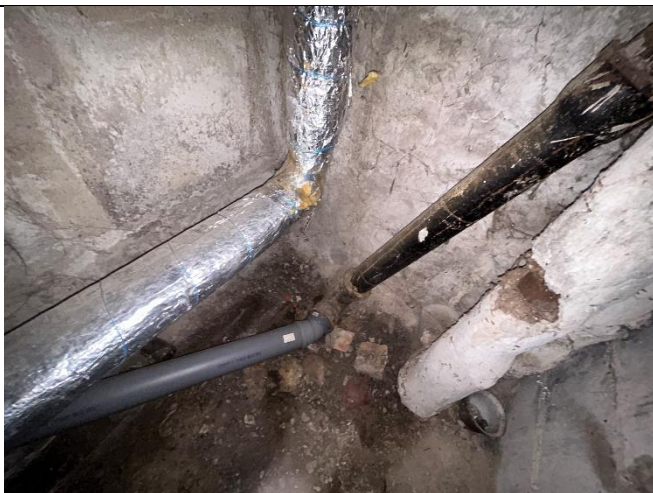
5.1.1. att. daļēji mainītas kanalizācijas caurules – čuguna un PVC cauruļu pārejas posms
