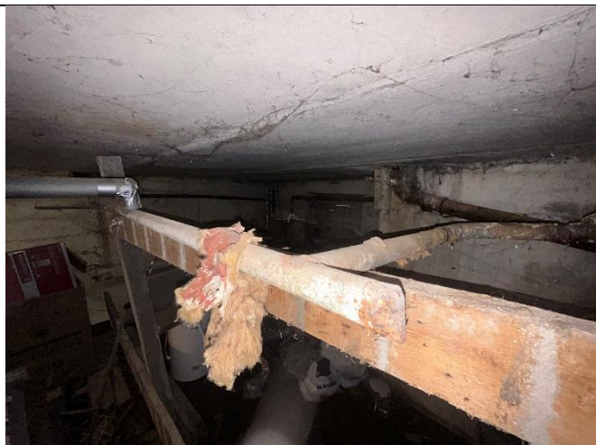
5.1.2. att. Nemainītas un daļēji siltinātas aukstā ūdens caurules
