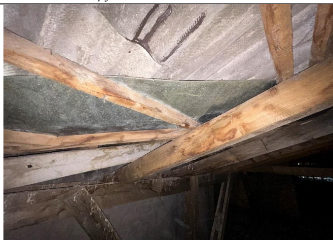
4.8.8. att. Mitruma pleķi uz pārseguma nesošajiem koka elementiem
