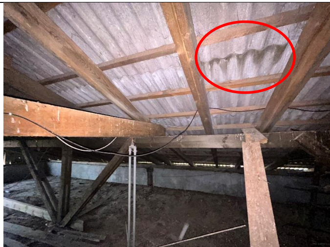
4.8.10. att. Ar mitrumu piesūkusies pārseguma loksne
