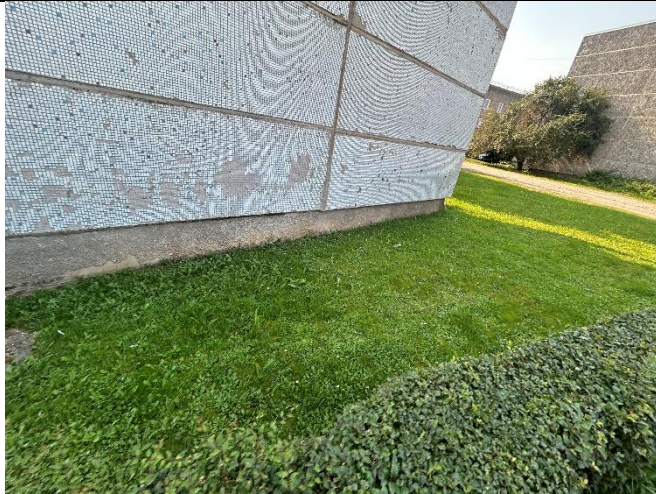
4.1.7. att. Neesoša aizsargapmale ēkas ziemeļu pusē
