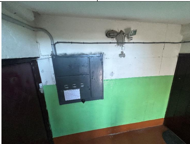
5.6.3. att. Elektrības skaitītāju kaste koplietošanas kāpņu telpās
