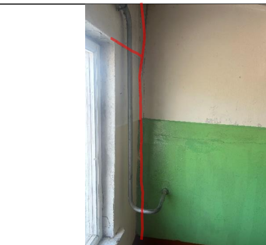
4.2.3. att. Vairākās vietās plaisas ārsienu paneļu savienojuma vietās un ārsienas un starpsienas savienojuma vietās
