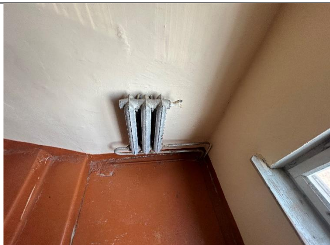
5.2.4. att. Čuguna radiators ēkas koplietošanas kāpņu telpā
