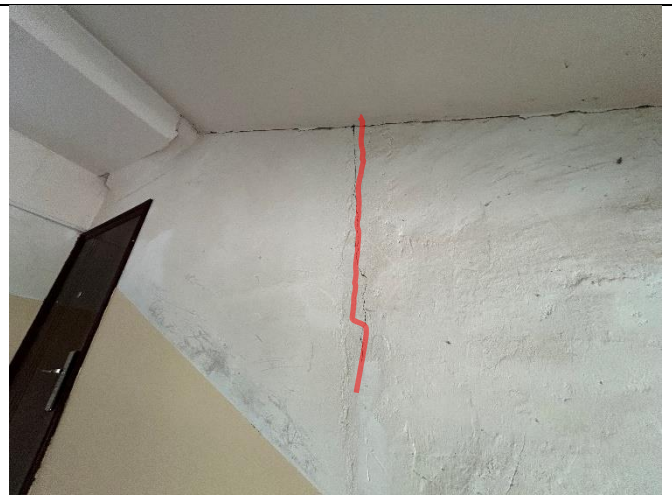
4.2.9. att. Vairākās vietās plaisas kāpņu telpas starpsienu paneļu savienojuma vietās
