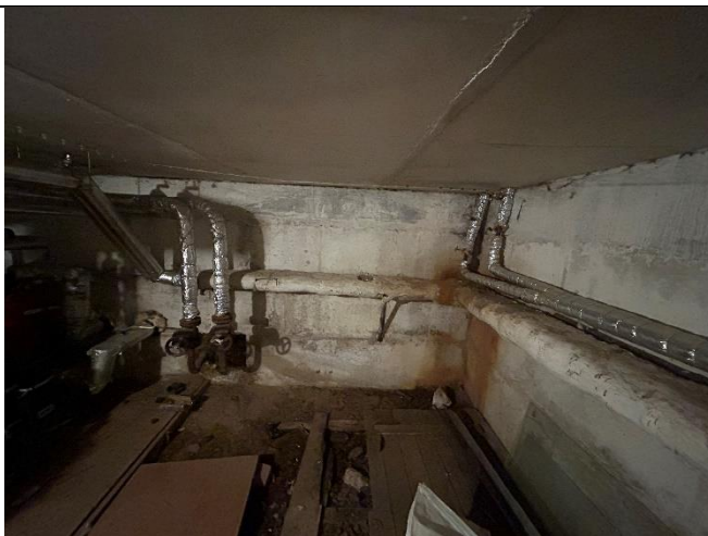
5.2.3. att. Siltināta apkures sistēmas siltumtrase, lielākoties saglabāta oriģinālā siltumizolācija un cauruļvadi
