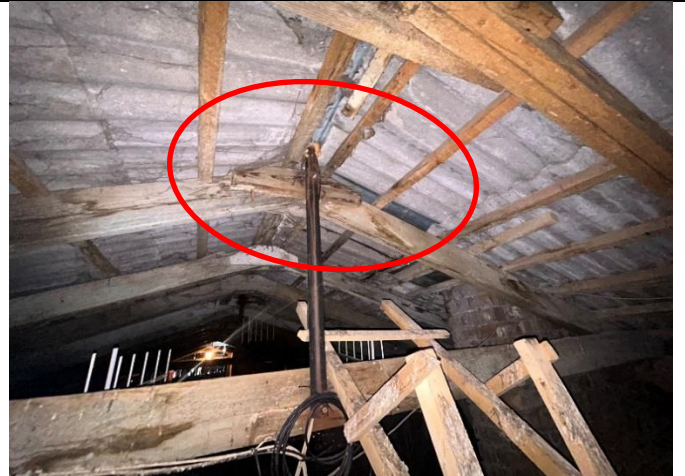
4.8.12. att. Mitruma pleķi uz pārseguma nesošajiem koka elementiem
