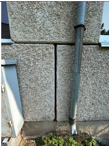
4.2.8. att. Izdrupusi paneļu savienojuma vietas šuve
