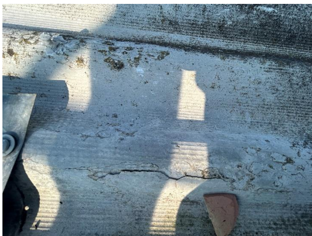
4.8.3. att. Vairākās vietās plaisas un erozija azbestcimenta jumta segumam
