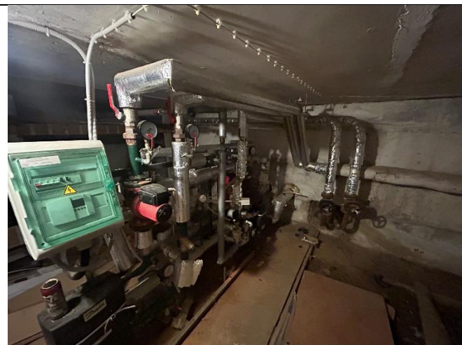
5.2.2. att. Ēkas siltummezgls
