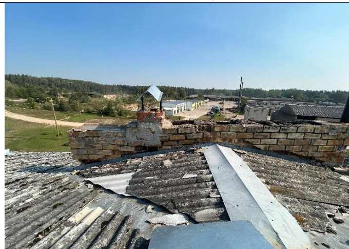
4.8.2. att. Abestcimenta seguma nodrupumi un labojumi, skārda nosegelementi
