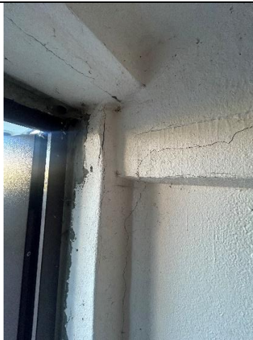
4.2.3. att. Vairākās vietās diagonālas plaisas zem kāpņu laukumiem
