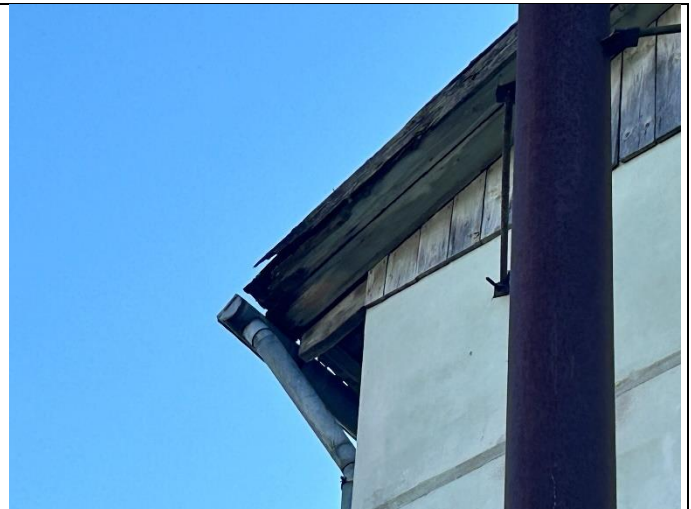
4.8.14. att. Vairākās vietās teknes deformētas, nav ar pareizu un pietiekamu kritumu. Vairākās vietās pa perimetru mitruma bojāti pārseguma koka elementi
