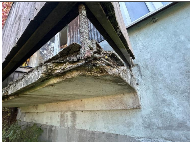
4.9.2. att. Balkonu konstrukcijas nodrupumi, atsegts stiegrojums un korodējušas metāla margas
