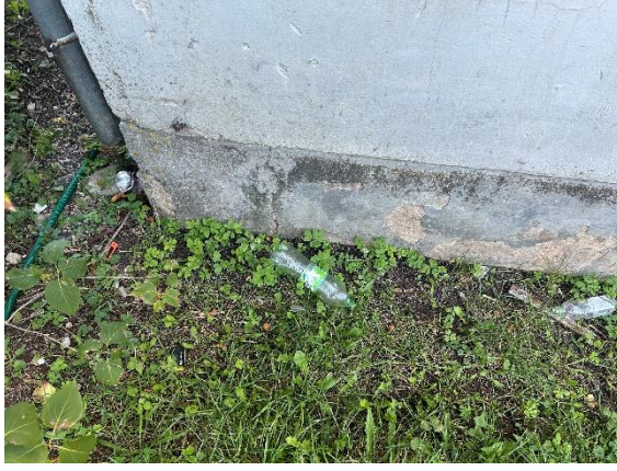
4.1.7. att. Plaisa pamatu konstrukcijā bloku savienojuma vietā
