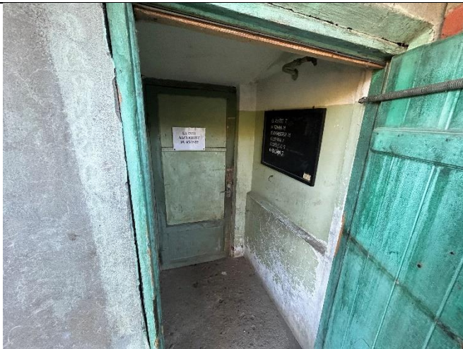
4.13.3. att. Nemainītas durvis no vējtvera uz kāpņu telpu
