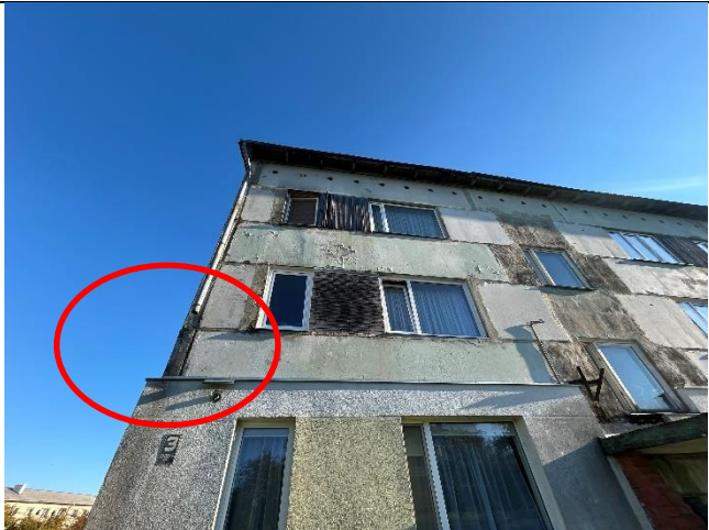
4.8.11. att. Vairākās vietās iztrūkstoši notekcaurules elementi novadot ūdeni uz fasādes un tiešā pamatu tuvumā
