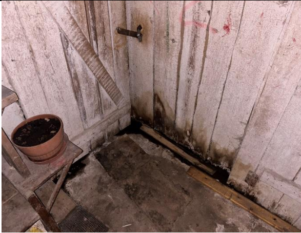
4.1.1. att. Mitruma radīti bojājumi, grīdas tuvumā, pagraba palīgtelpu koka konstrukcijas sienām
