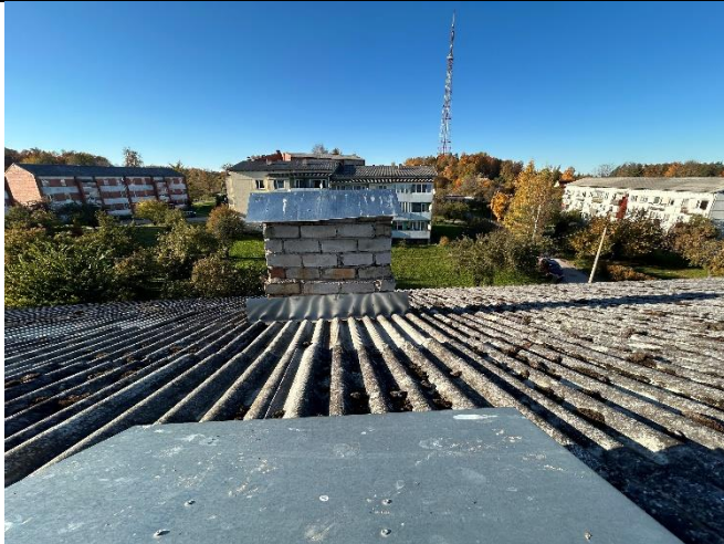
5.5.1. att. Ventilācijas izvadkanāls virs jumta ar skārda nosegecupuri
