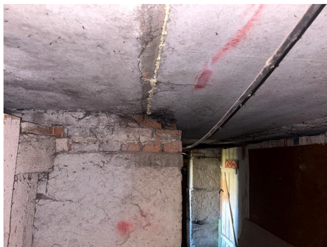
4.6.1. att. Sprauga pagraba griestu plātņu savienojuma vietā, kas aizpūsta ar montāžas putām
