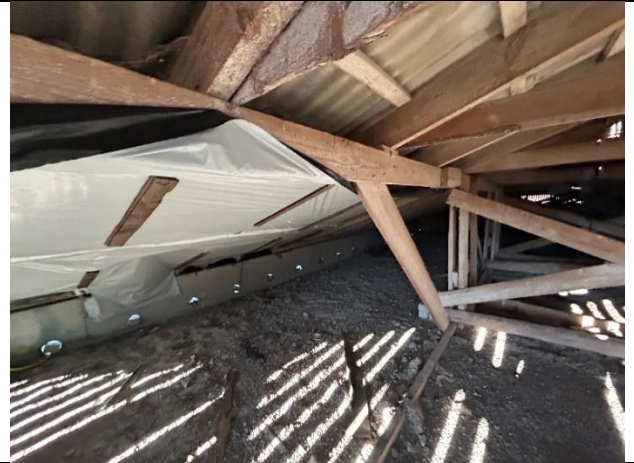
4.8.2. att. Zem azbestcmenta lokšņu seguma uzstādīta plēve, iespējams, ar nolūku novadīt lietus ūdeni vietās, kur segums ir bojāts
