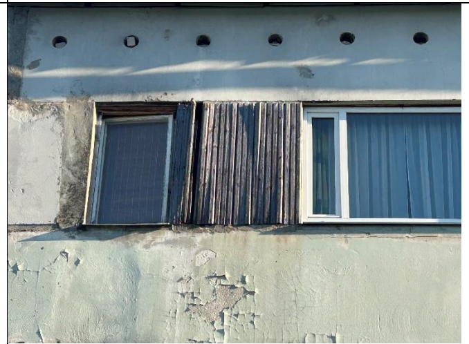
4.19.4. att. Bojāta starplogu konstrukcijas un vieglbetona paneļu apdare
