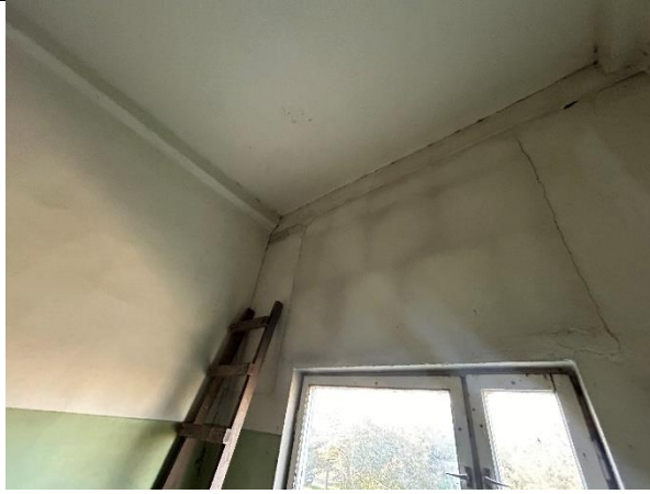
4.2.1. att. Vairākās vietās plaisas ārsienu konstrukciju šuvju vietās, spraugas starpsieni un starpstāvu segumu saduršuvju vietās. Vairākās vietās novērojams mitrums vieglbetona bloku ārsienu šuvju vietās
