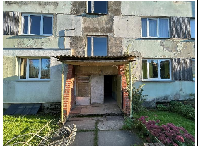
4.9.6. att. Ieejas mezgla konstrukcija. Ieliecies dzelzsbetona segums – pirmsavārijas stāvoklis
