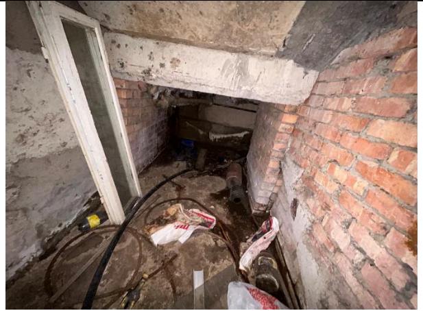
4.1.2. att. Mitra pagraba grīda un ar mitrumu piesūkusies pamatu dzelzsbetona bloku konstrukcija zem kāpņu telpas
