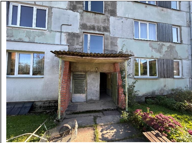
4.19.1. att. Kāpņu telpas vieglbetona bloku aizmūrējums – mitruma piesātināts
