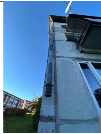
4.8.10. att. Vairākās vietās iztrūkstoši notekcaurules elementi novadot ūdeni uz fasādes un tiešā pamatu tuvumā
