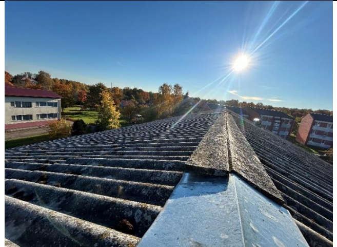
4.8.8. att. Kores koka nosegelementi – nenodrošina pietiekamu hidroizolāciju
