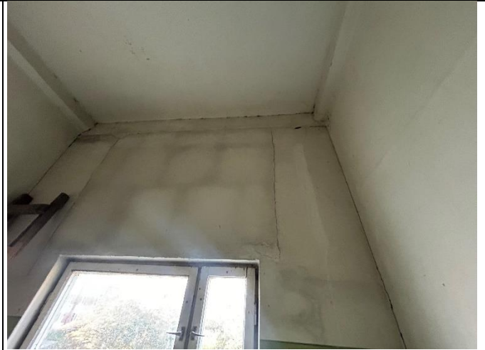
4.6.4. att. Spraugas bēniņu grīdas pātņu un ārsienas sadurvietā
