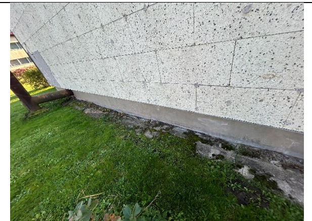
4.1.6. att. Vairākās vietās betona aizsargapmale ar apaugumiem, saplaisājusi, bojāta un ar nepietiekamu vai uz pamata konstrukciju vērstu kritumu
