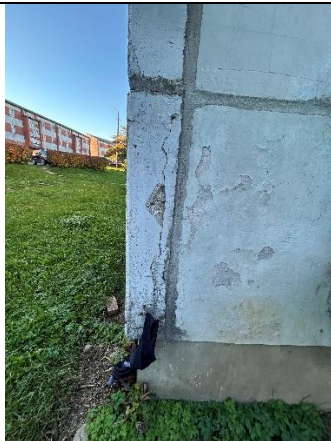
4.2.5. att. Plaisas ārsienu panelī ar atsegtu, korodējušu stiegrojumu nodrupuma vietā
