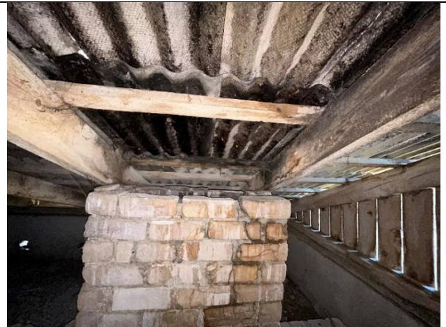
4.8.6. att. Azbestcmenta lokšņu seguma mitruma bojājumi zem ventilācijas šahtām
