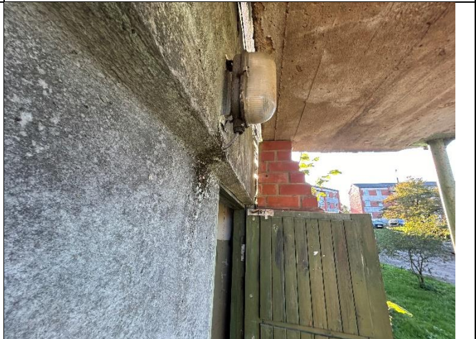
4.9.8. att. Ieejas mezgla konstrukcija nosēdusies – sprauga starp fasād
