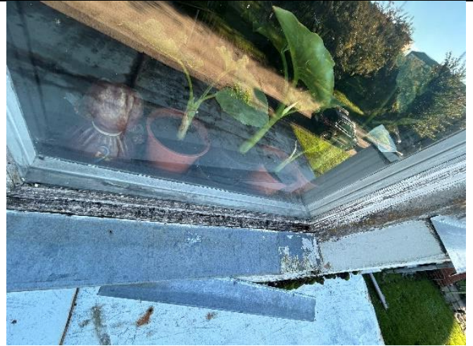
4.5.4. att. Oriģinālā palodze ar spraugām pa iestrādes perimetru.
