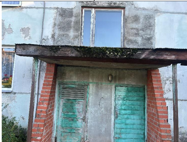
4.9.10. att. Ar mitruma piesūcināts un veģetatīvi apaudzis jumtiņu perimetra koka nosegelements
