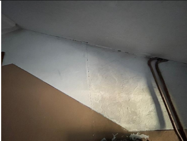
4.10.1. att. Vairākās vietās spraugas starp kāpņu laidiem un starpsienām
