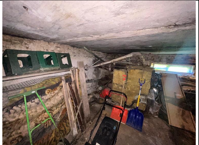
5.2.2. att. Malkas apkures katls (neizmanto)
