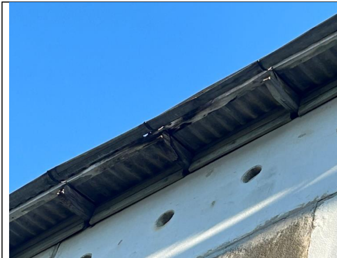
4.8.13. att. Vairākās vietās teknes deformētas, nav ar pareizu un pietiekamu kritumu. Vairākās vietās pa perimetru mitruma bojāti pārseguma koka elementi
