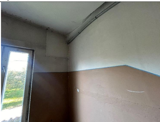
4.10.5. att. Spraugas kāpņu laukumu un ārsienu sadurvietās
