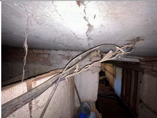
5.6.3. att. vairākās vietās nesakārtoti, haotiski izkārtoti elektrības vadi
