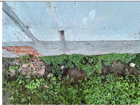
4.1.5. att. Vairākās vietās iztrūkstoši betona aizsargapmales posmi
