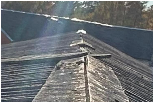
4.8.9. att. Iztrūkstoši kores nosegelementi – nenodrošina hidroizolāciju
