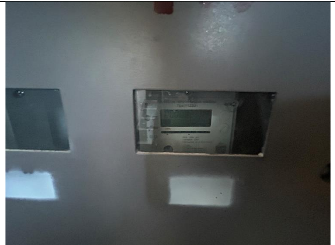
5.6.4. att. Viedie elektroenerģijas skaitītāji katram dzīvoklim, katrā stāvā.
