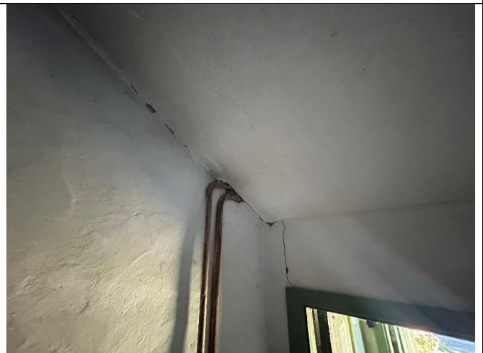
4.2.12. att. Vairākās vietās plaisas zem kāpņu laukumiem sienu un logu pārsedžu daļā.
