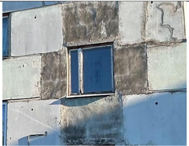
4.2.10. att. Vieglobetona bloku aizmūrējumi ap logiem kāpņu telpas daļai. Augšējā labajā stūrī aizspaktelētas caurejošas vieglobetona paneļa plaisas.
