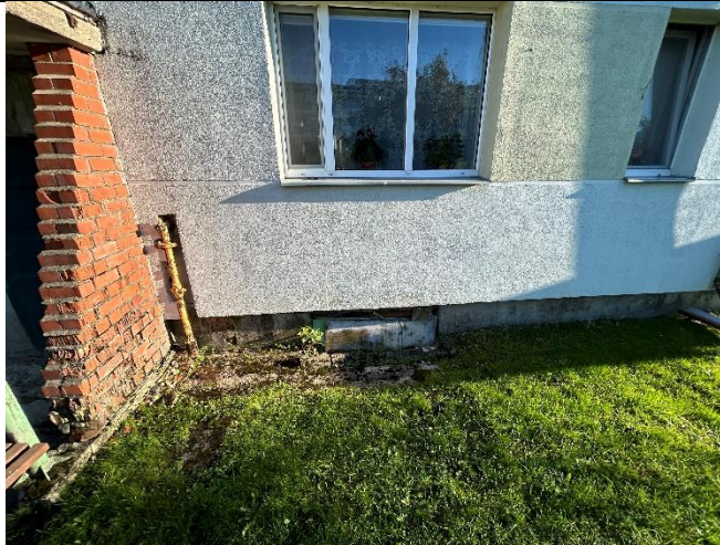
4.1.9. att. Bojāta betona aizsargapmale virs logailas apakšējās daļas līmeņa, šajā vietā nenodrošinot ūdens novadīšanu no pagraba loga, kas nehermētiskas iestrādes vai bojājumu gadījumā veicina ūdens iekļūšanu pagraba telpās
