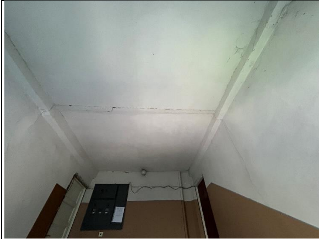
4.6.3. att. Spraugas bēniņu griestu plātņu savienojuma vietās
