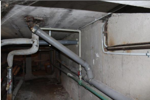
5.1.1. att. Aukstā ūdens aprites cauruļvadi
