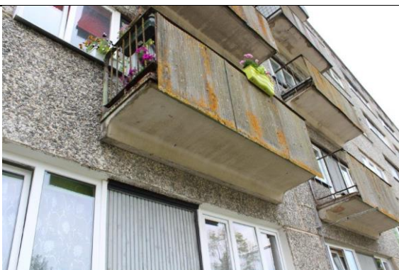
4.9.7. att. Balkonu nesošās konstrukcijas
