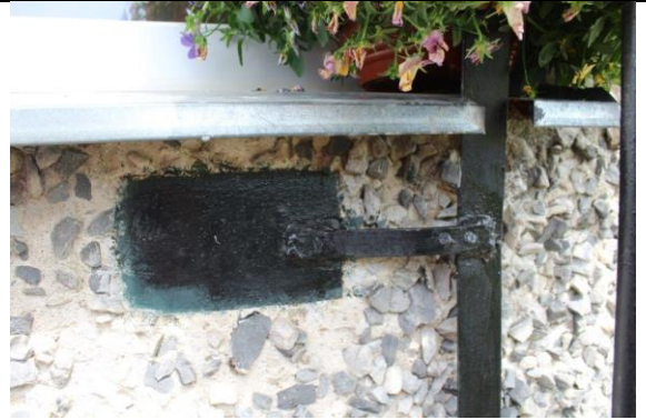
4.9.20. att. Balkonu nesošās konstrukcijas
