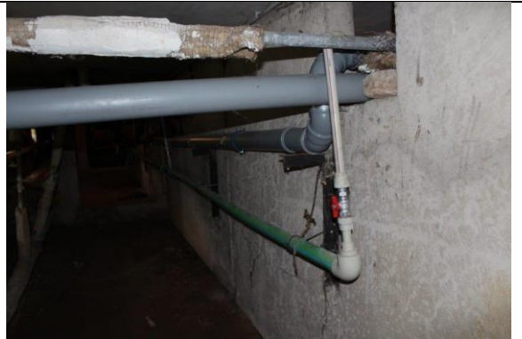
5.1.2. att. Aukstā ūdens aprites cauruļvadi
