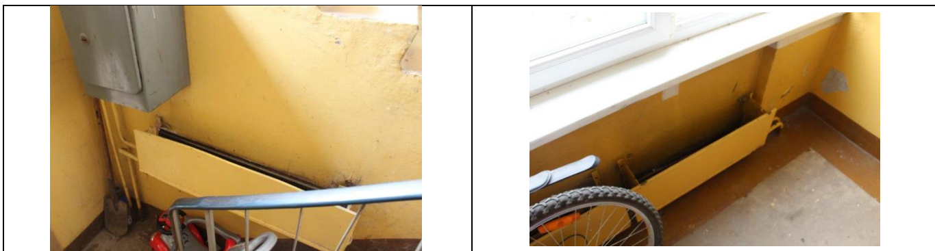
5.5.3. att. Metāla radiatori kāpņu telpā
