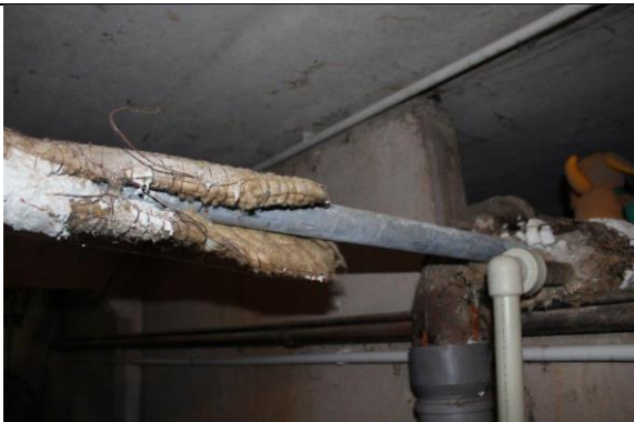
5.1.5. att. Aukstā ūdens aprites cauruļvadi
