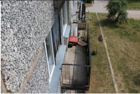
4.9.19. att. Balkonu nesošās konstrukcijas
