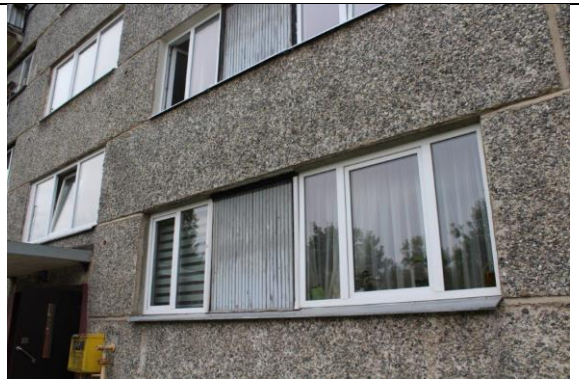
4.13.8. att. PVC konstrukcijas logu aizpildījumi dzīvokļos
