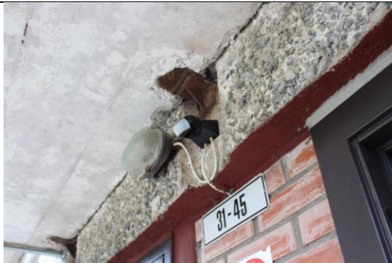
5.9.7. att. Elektroapgādes sistēmas elementi ieejas mezglā – kustību sensors
