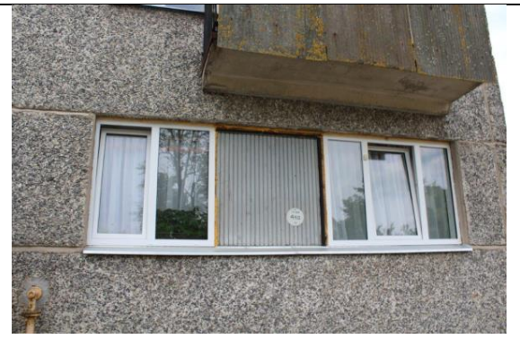
4.13.10. att. PVC konstrukcijas logu aizpildījumi dzīvokļos
