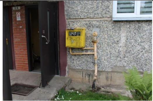
5.8.2. att. Gāzes apgādes ievads iecjas mezglā
