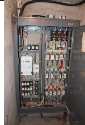
5.9.6. att. Elektroapgādes sadalne pagrabstāvā
