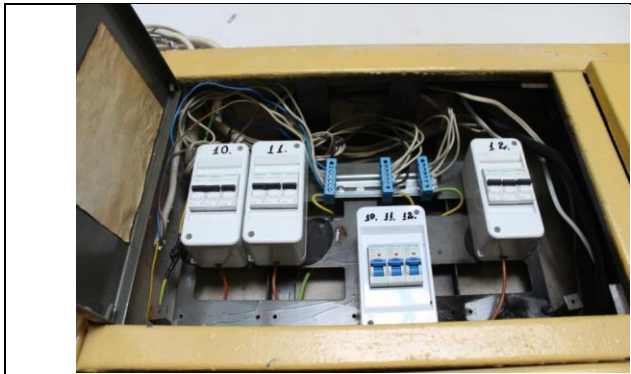
5.9.3. att. Komunikācijas sadalne kāpņu telpā
