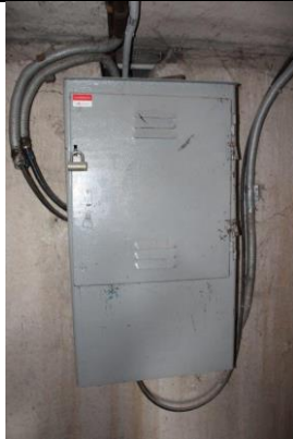
5.9.5. att. Elektroapgādes sadalne pagrabstāvā
