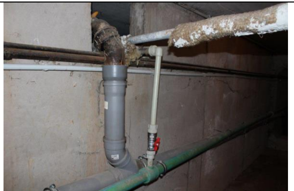
5.1.4. att. Aukstā ūdens aprites un kanalizācijas cauruļvadi
