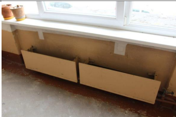
5.5.1. att. Metāla radiatori kāpņu telpā
