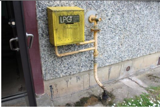
5.8.1. att. Gāzes apgādes ievads iecjas mezglā
