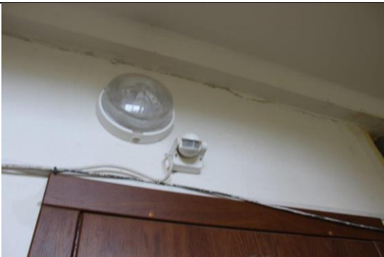
5.9.1. att. Elektroapgādes sistēmas elementi kāpņu telpā – kustību sensors
