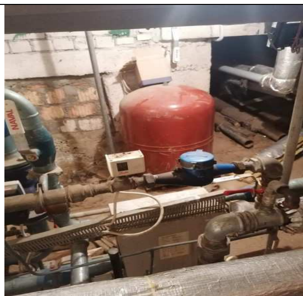
Attēls Nr.7, Ēkas siltummezgls
