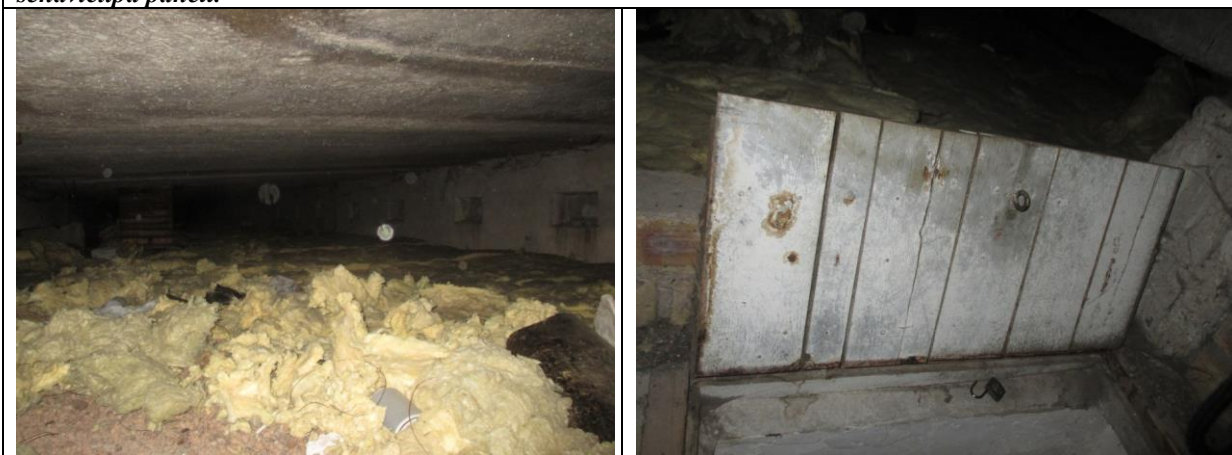
21. un 22. attēls. Ēkas augšējā pārseguma vēdināmā starptelpa siltināta ar keramzībetona oļiem un akmens vates plāksnēm. Akmens vates siltumizolācijas slānis nav vienmērīgi uzklāts, līdz ar to, ieteicama šī slāņa sakārtošana un papildu pārseguma siltināšana ar beramo siltumizolācijas slāni, nodrošinot arī starptelpas atbilstošu vēdināšanu caur ventilācijas sānu restēm.
