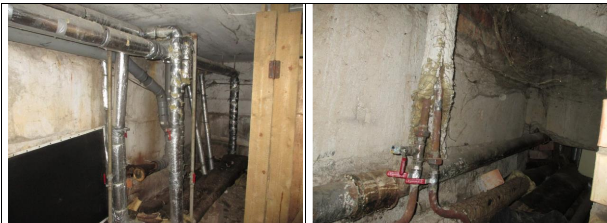
13. un 14. attēls. Apkures un karstā ūdens cauruļvadi ēkas pagrabstāva telpās. Atsevišķiem cauruļvadu posmiem veikta siltumizolācijas slāņa atjaunošana.
