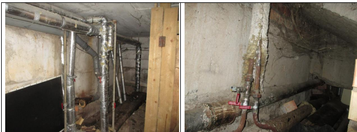
13. un 14. attēls. Apkures un karstā ūdens cauruļvadi ēkas pagrabstāva telpās. Atsevišķiem cauruļvadu posmiem veikta siltumizolācijas slāņa atjaunošana.
