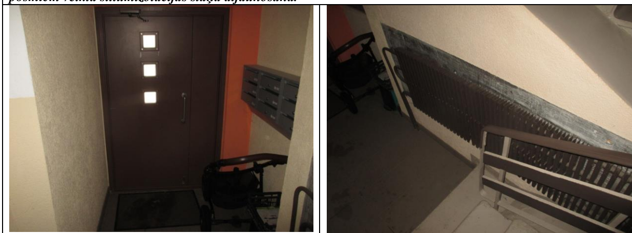
15. un 16. attēls. Ēkas kāpņu telpām uzstādītas jaunas metāla ārdurvis ar automātiskiem aizvēršanas mehānismiem. Kāpņu telpu sildķermeņi saglabājušies, nomainītie konvektori.
