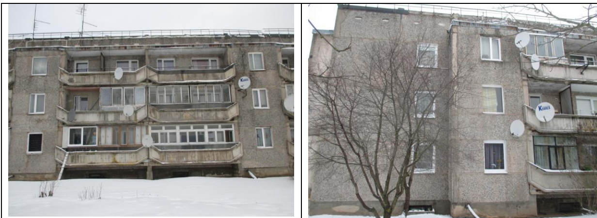
19. un 20. attēls. Ēkas lodžijas. Augšējā stāva lodžiju pārsegumos novērojama lietusūdens iesūkšanās un migrācija pa pārsegumu uz ārsienām. Veicot ēkas atjaunošanu, ir ieteicama arī lodžiju pārsegumu siltināšana un lodžiju aizstiklošana ar energoefektīvu stikla paketi un margas paneļa nomaiņa pret siltinātu, sendvičtipa paneli.
