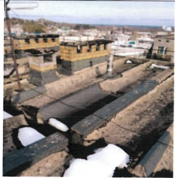
2.attēls- ventilācijas šahta virs jumta
